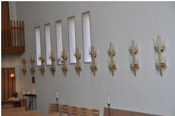
Befintlig armatur med nya energisnåla ljuskällor
