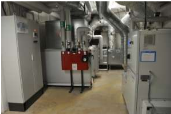
Ny teknikcentral i domkyrkans källare med bl.a avfuktare och befuktare.
