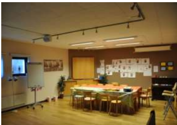
Förbättrad belysning installerad i ungdomsrummet S:t Johannes
