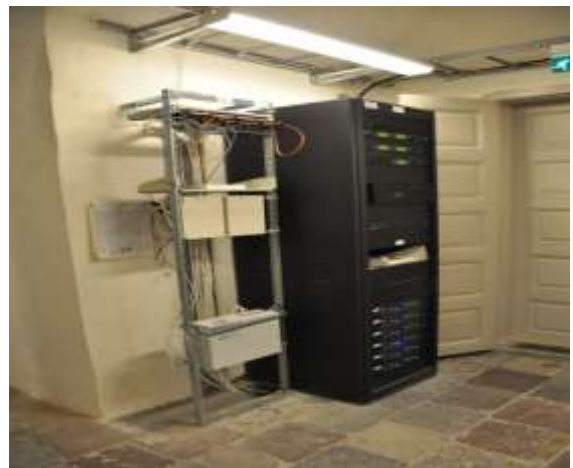
Ny teknikskåp avseende ljud/ljusfunktioner i domkyrkan
