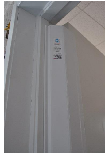
Skyddslist mot klämrisk i Två systrars barnrum
