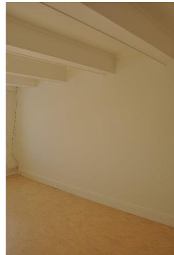
Vattenskada i ett arbetsrum i Berga kapellgård, resulterade till byte av element och golv samt ljudisolering av vägg intill grannens arbetsrum
