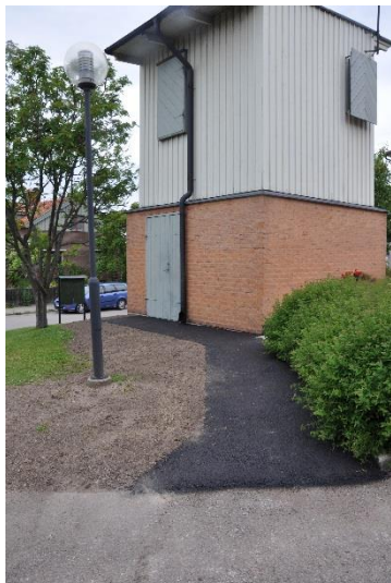
Stuprör nersänkt i marken och påkoppling till dräneringsrör samt asfaltering intill klocktornet
