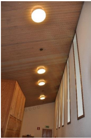
Takbelysning på orgelläktare
