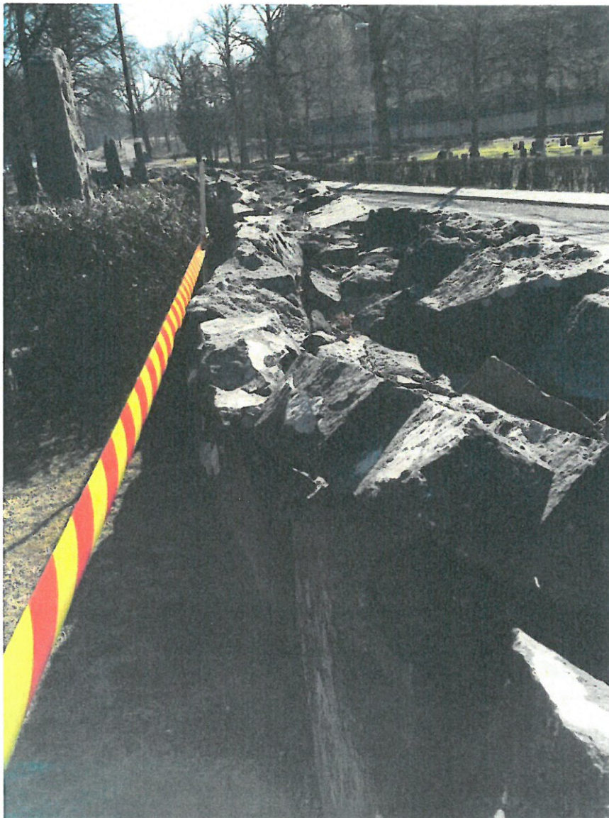
Bild som visar att murens inre faller samman och trycker ut granitmurskallen mot kyrkogård och gata. I det här partiet är muren deformerad.
