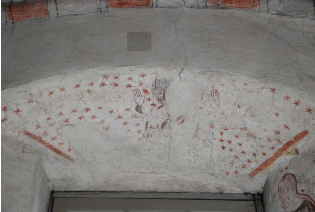
Bild 2: spricka över fönstret i sakristian.
