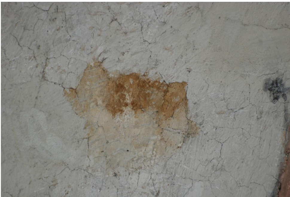
Bild 9: detalj av sprickbildning och missfärgning (detalj av bild 8).
