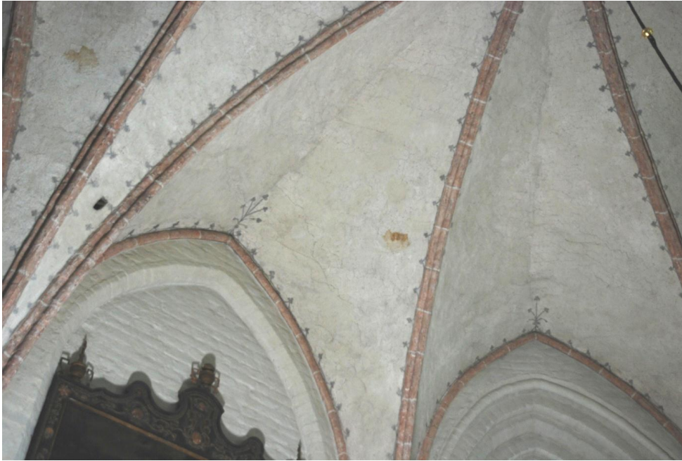
Bild 8: långhusets norra valvkappor med missfärgningar
