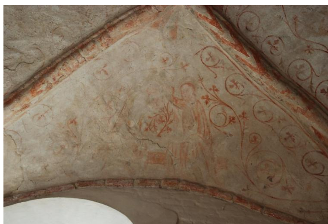
Bild 4 (t.h.): korets södra valvkappa, Jungfru Marie kröning. Ungefär i mitten av bilden syns en tvärgående putsspricka (se även bild 5) som eventuellt behöver säkras med kantlagning.
