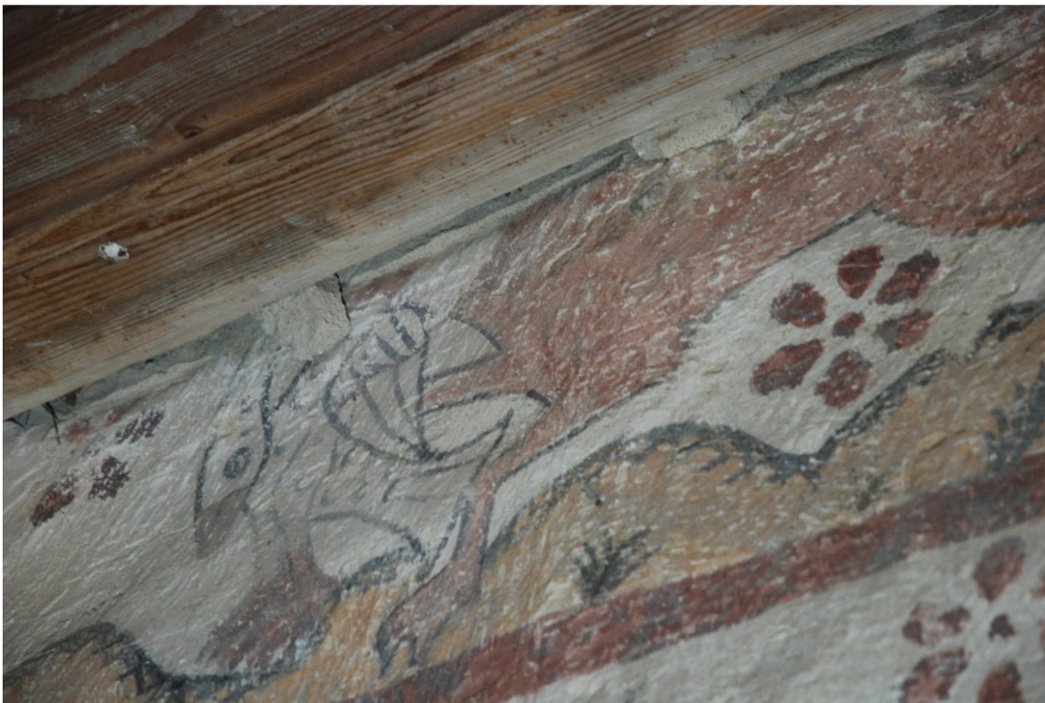
Bild 10: sakristians sydvägg. Över lekscenen syns en springande räva med en gås i munnen, och en annan gås nappar efter rävens svans. Ett stycke puts har lossnat och fallit ned över måleriet. Detta har skett efter 2011.
