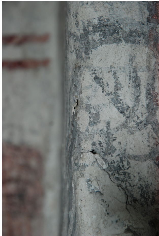
Absiden, exempel på sprickbildning. Putsen har omfattande bom, men de flesta sprickor är inte ”öppna” som denna och konserveringsbehovet är inte akut. Dock kan putsen vara vibrationskänslig och måste noga övervakas vid eventuella arbeten i och vid kyrkan.
