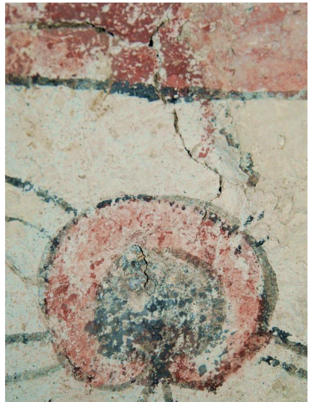
Korets östvägg, detaljbilder. T.v. retuscher och sprickor i Guds ansikte. Strax nedanför hakan syns bakkdelen av en duva, den Helige Ande. T.h. den målade bården nedanför Nådstolen, med små öppna sprickor i putsen.
