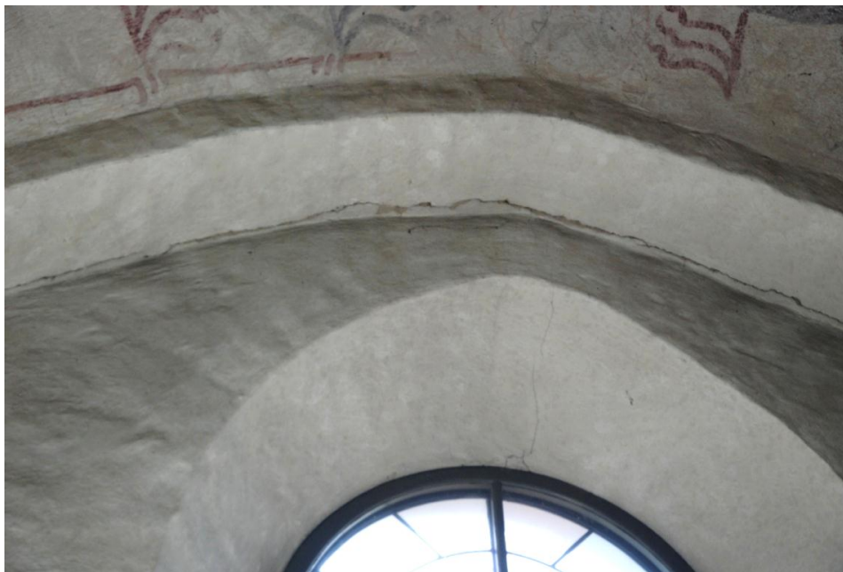
Bild 2: spricka i valvbågen över södra långhusväggen östligaste fönster.
