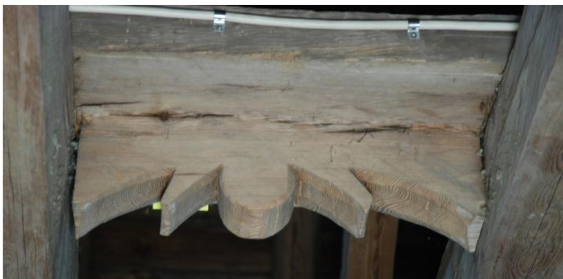
Den romanska takstolens styrplanka, med kabeldraging.
