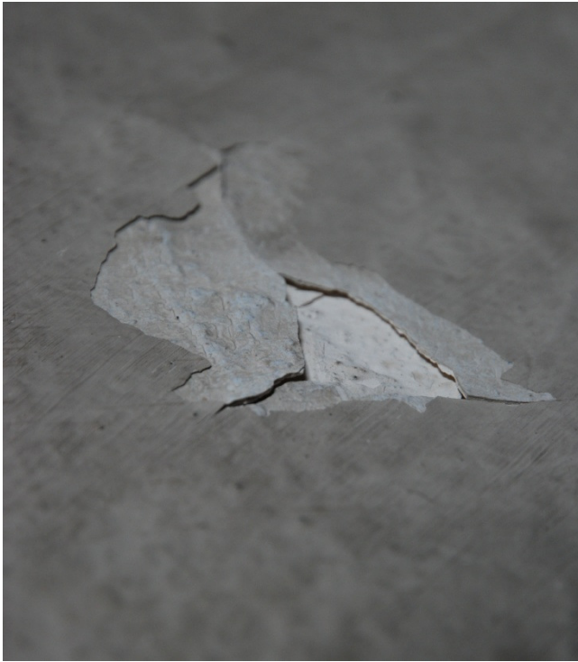
Bild 8: skada på långhusväggen nära predikstolen
