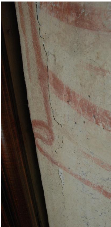
Bild 13: längsgående spricka i putsen mot dörren
