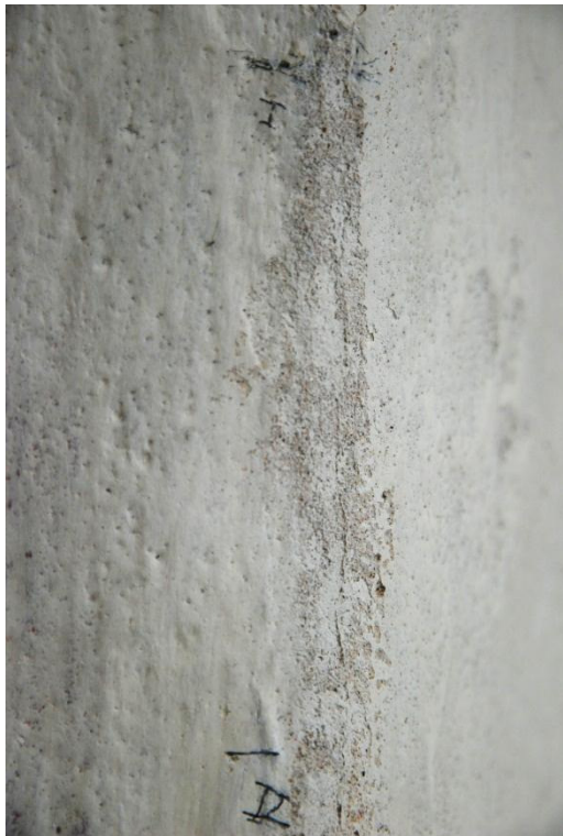
Bild 5: provyta lagningsbruk I, med längsgående hårfin spricka.
