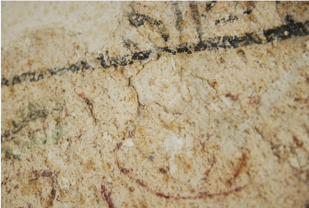
Detalj av strappon. Skada i form av öppen putskant, åtgärdas i samband med annat arbete.
