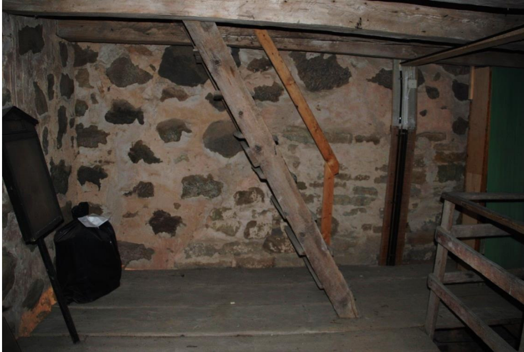
Våning 4, östra väggen, där kalkstensmurverket smalnar av till ett gavelröste. Övre delen av röset har skrotats av och resten av tornets östra mur rider på långhusväggen.
