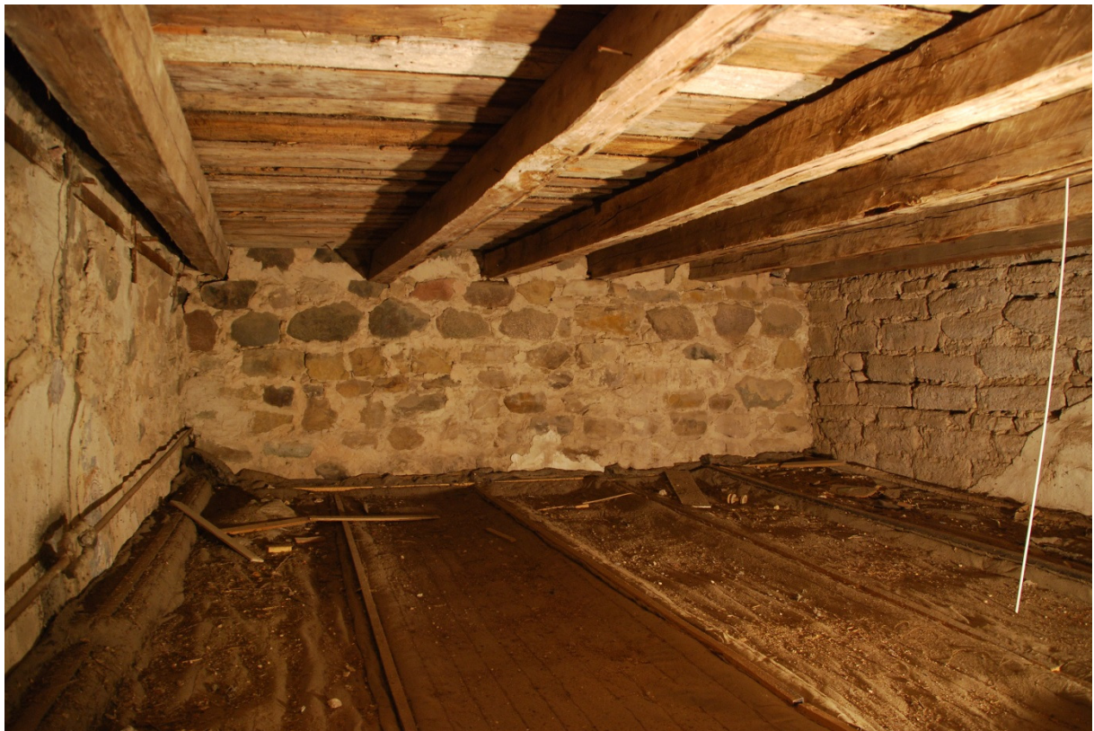
Våning 2, vy mot norr. De västra och östra väggarna med sina valvformade putspartier. På bortre (norra) väggen syns också puts, betydligt mer skadad.
