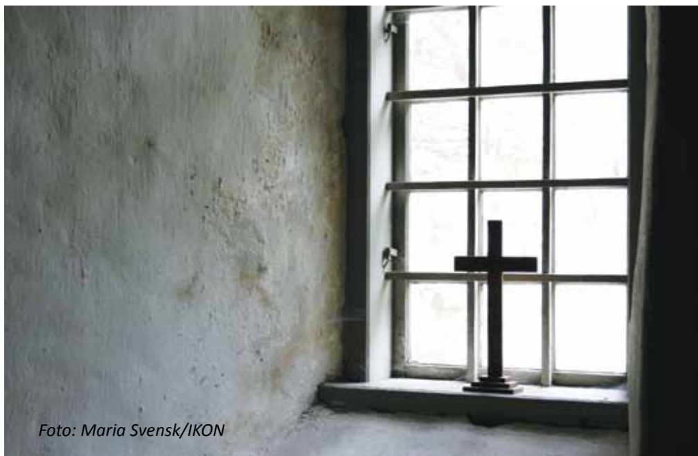
Fuktskada på vägg vid fönster.
