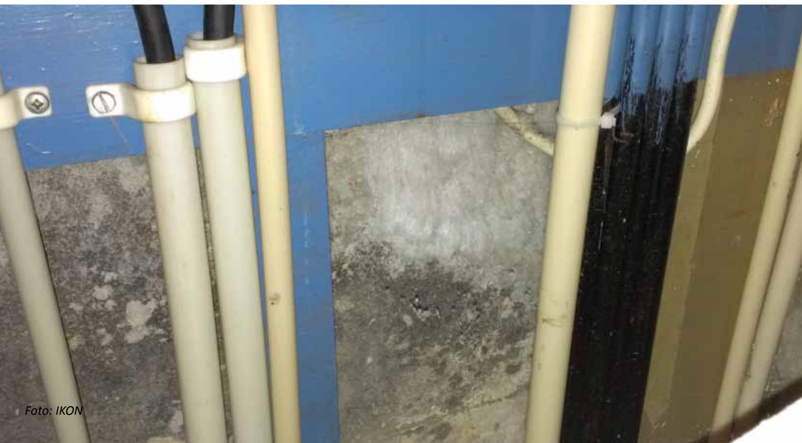
Saltkristaller på väggen i ett elskåp.
