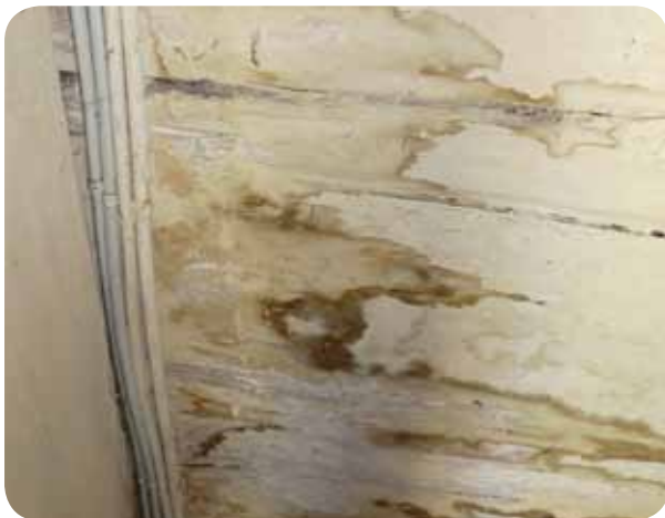
Fuktrosor i taket.
