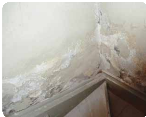
Saltskador på insidan av yttermuren.
