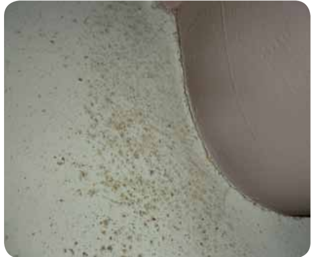
Infästningen, i närbild, där det bildats ett mikroklimat med mögelpåväxt som följd.
