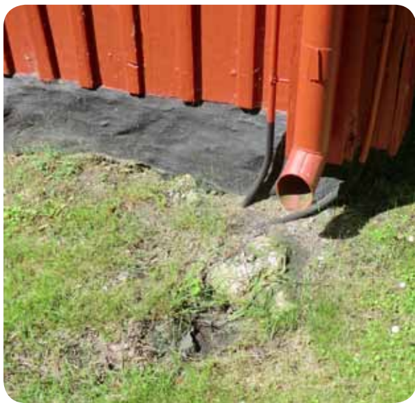
Gropen under stupröret gör att vatten inte leds bort på bästa sätt.
