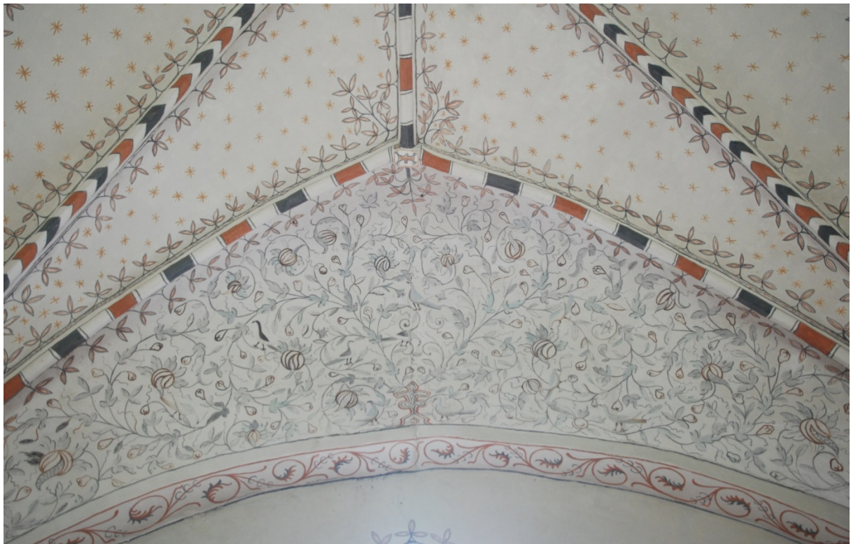
Norra valvkappan med Forsslunds dekormåleri. En lodrätt spricka löper genom valvkappans mitt.
