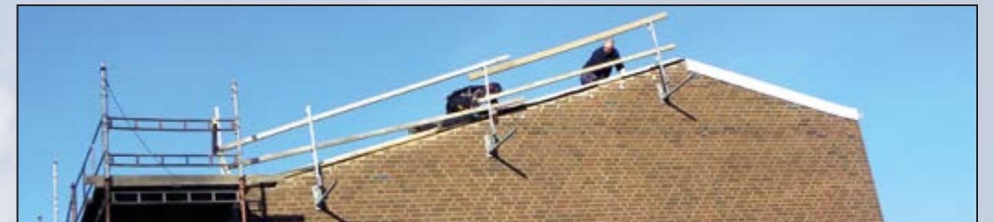
Det dåliga taket åkte av och arbetet med att lägga ett nytt påbörjades. 2015-03-21
