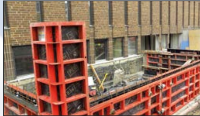
Här skall det nya andaktsrummet vara. Den murade väggen bakom är nu en del av interiören och de smala fönstren finns fortfarande kvar mot stora salen. 2015-04-30
