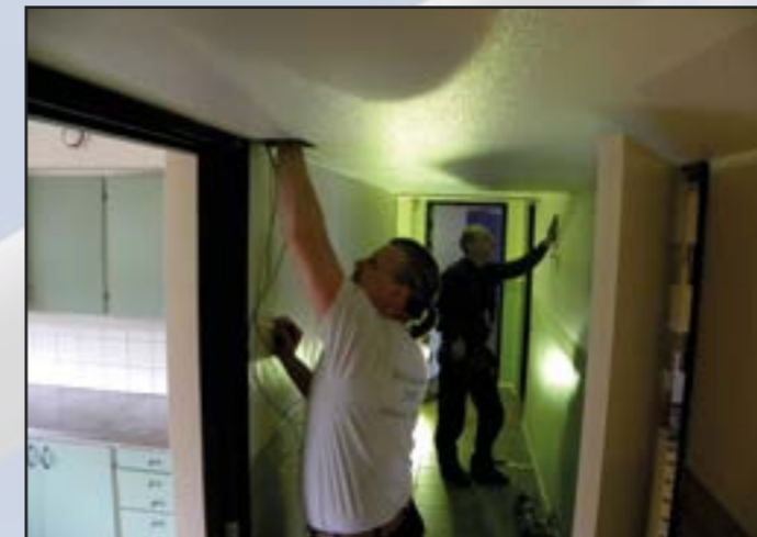
Byggstart. Efter veckor av flytt och magasinering, kom arbetet igång. Kablar skall bort och nya skall dras. 2015-02-26
