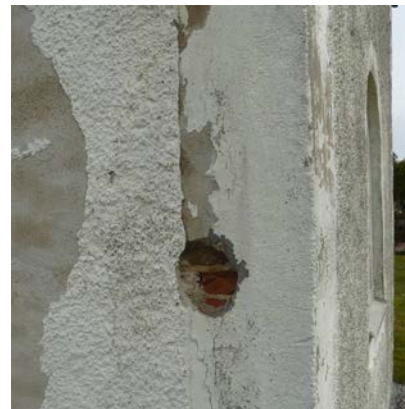
Bårhuset har skador i putsen och behöver målas om.
