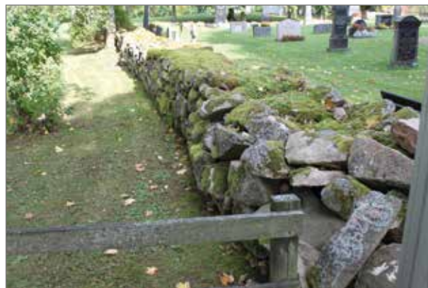
Delar av den västra delen av gråstensmuren som har börjat kalva ur.
