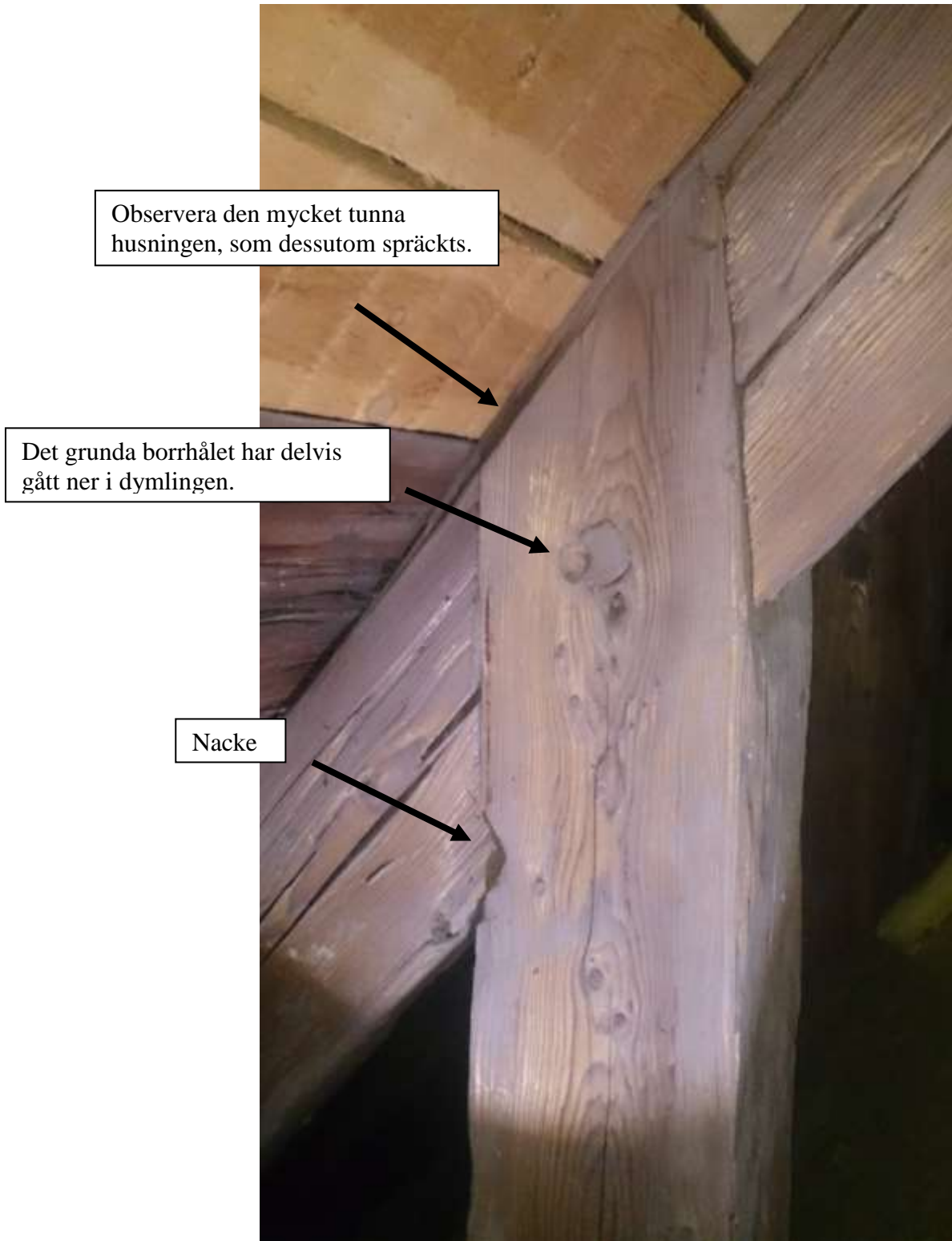
Stödbenets anslutning mot högbenet. Husad knut med nacke. Observera det grunda borrhålet som uppstått vid genomborrning av knutpunkten på den ovanliggande takstolen.
