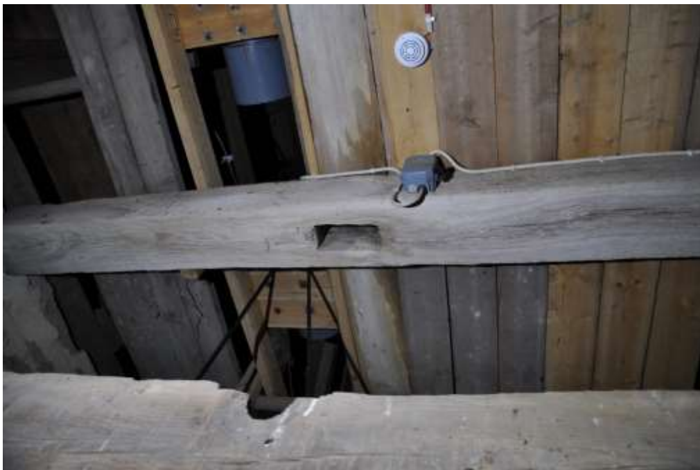
Den mittre av de tre ursprungliga bjälkarna som ingått i den första tornhuvens konstruktion. I mitten syns ett tapphål där tornhuvens hjärtstock tidigare stått.
