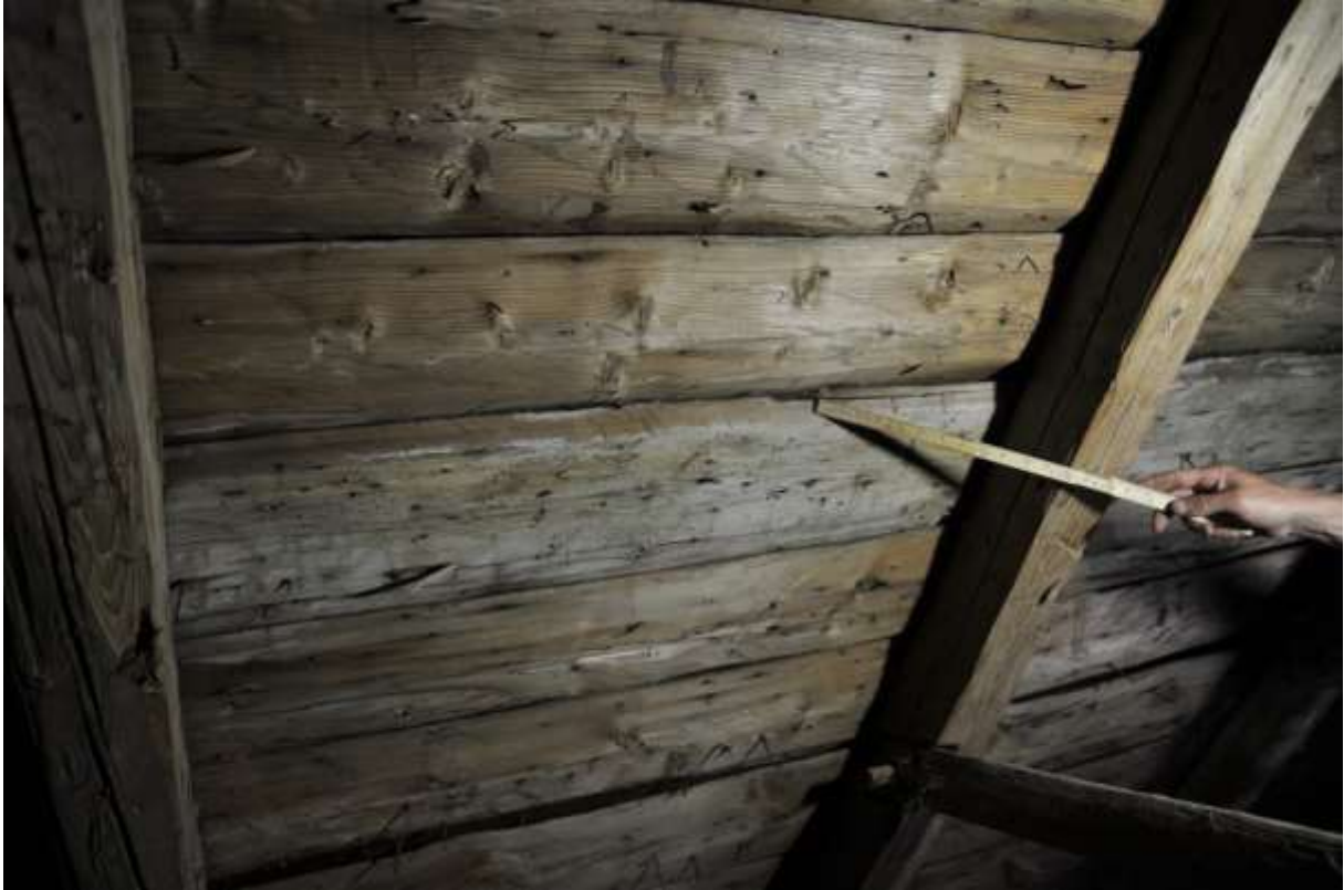
Återanvänd bräda i undertaket? Spår av vit färg samt en felvänd fasning vid tumstocken.
