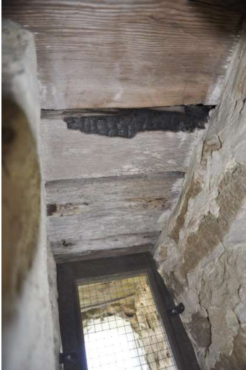
Brandskadat virke i ljudöppningarna.
