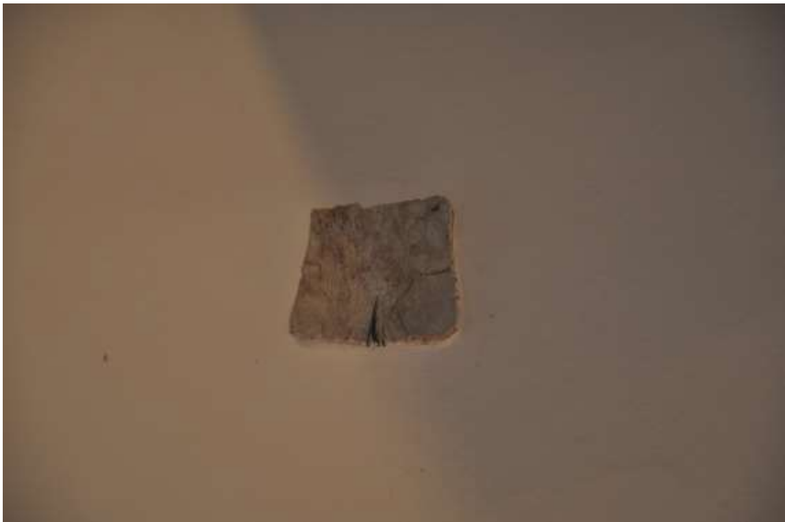
Avkapad bjälke, synlig i långhusets södra vägg.
