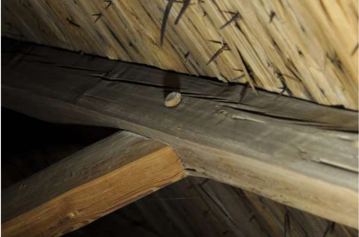
Mycket omsorgsfullt täljd "spikskalledymning". Takstol typ A, med vibrationsspår från skave samt rester av vit färg.
