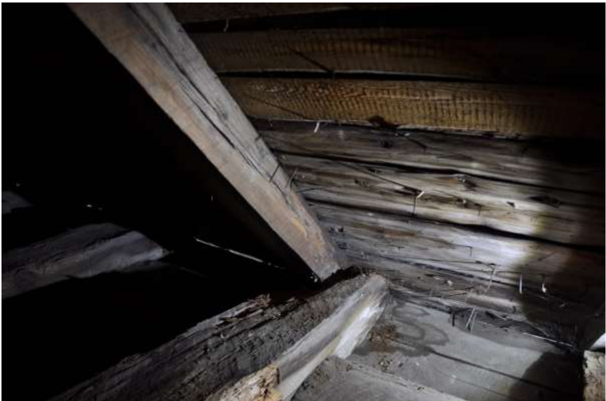
Pågående takläckage vid norra takfoten. Här finns långhusets enda bevarade taktro.*
