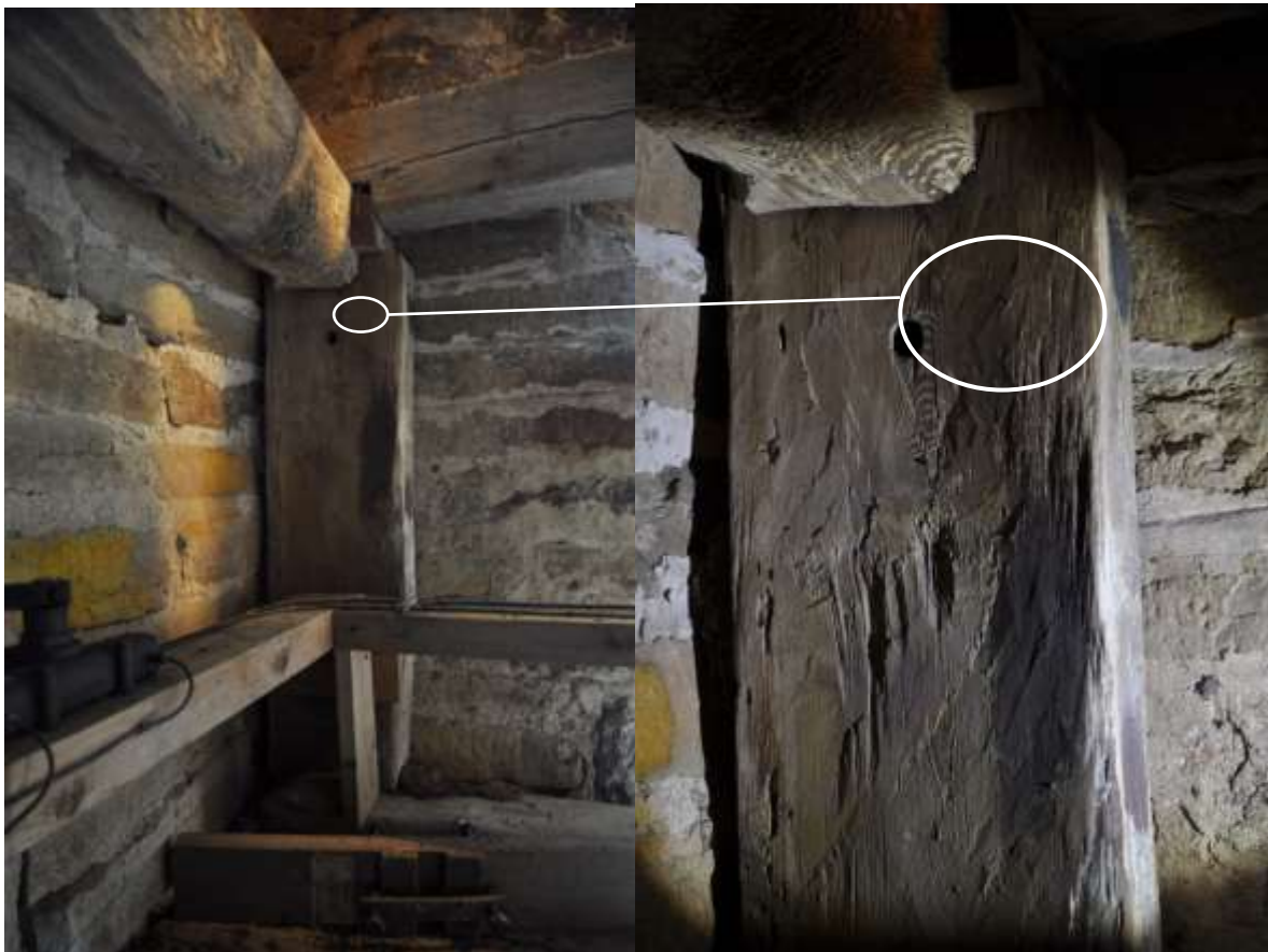
Den ena av de två stolparna som består av återanvänt virke. De uppvisar en variant av sprätthuggning (slinthuggning) samt en dimension som för tankarna till medeltida klocktorn.
