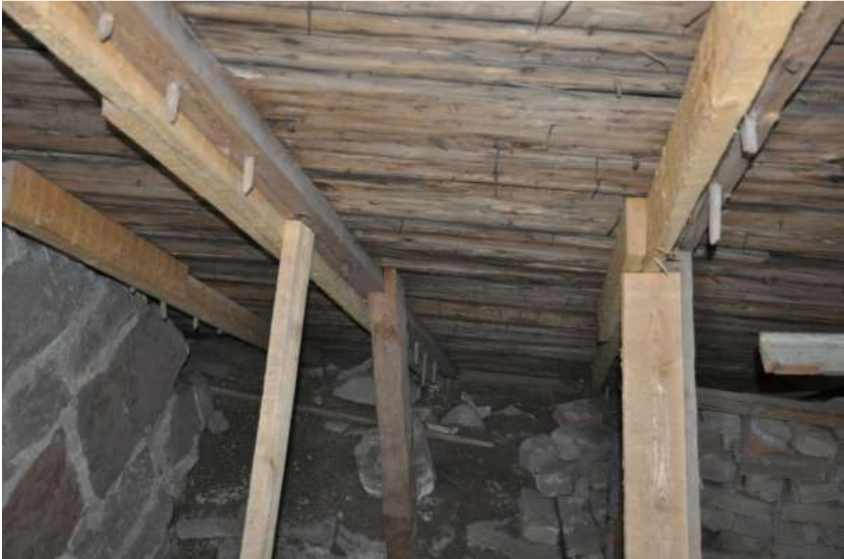
Undertaket består till största delen av brädor som är framställda genom klyvning och behuggning. De är fästa mot högbenen med genomgående tränaglar.
