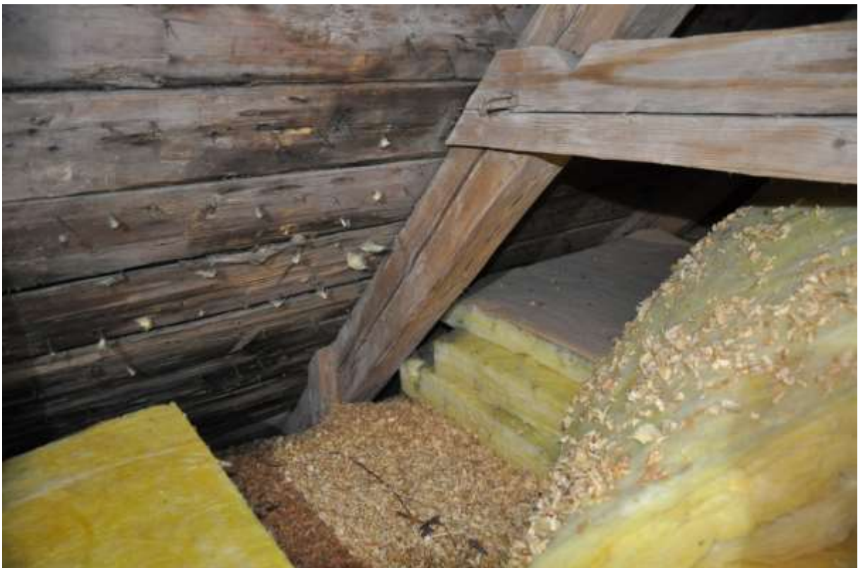
Remstycket är svåråtkomligt på grund av långhusets valv samt isoleringen.
