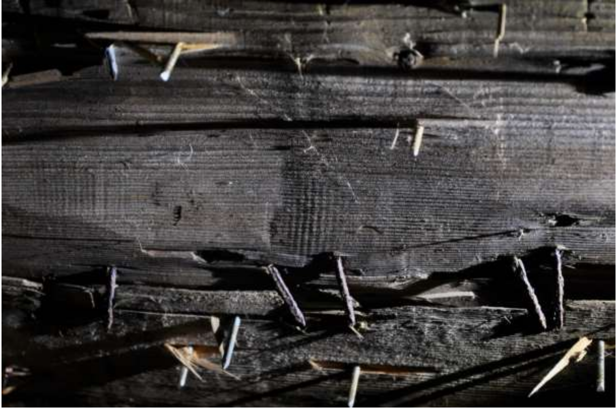
Spår av skave på en undertaksbräda i klockstapelns tornhuv.
