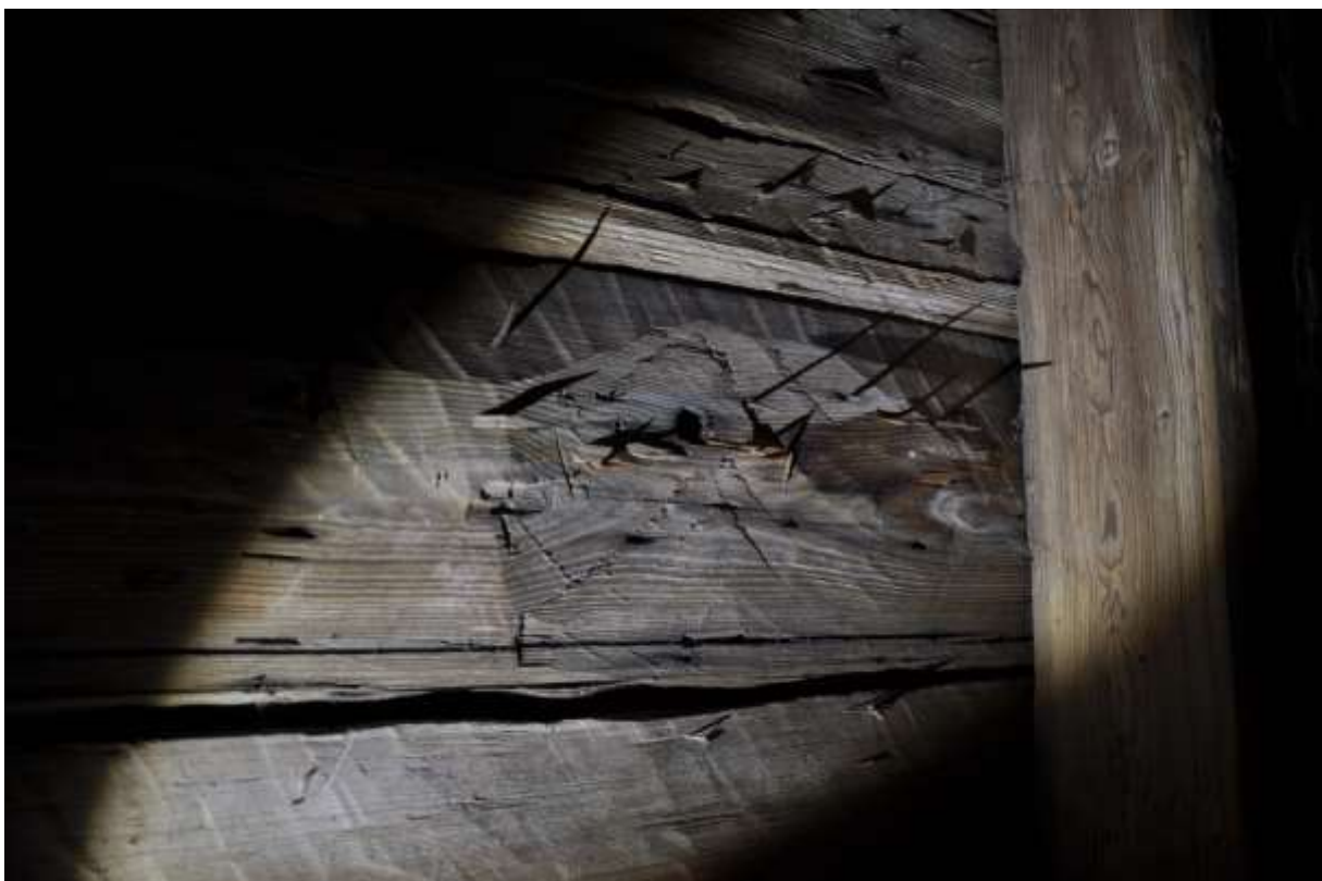
Ett stort antal tidigmedeltida brädor finns bevarade. Mitt i bild kan man se att ytan justerhuggits för att brädan skulle ligga bra an mot sparren i sin tidigare konstruktion, samt ett borrhål för en tränagel.
