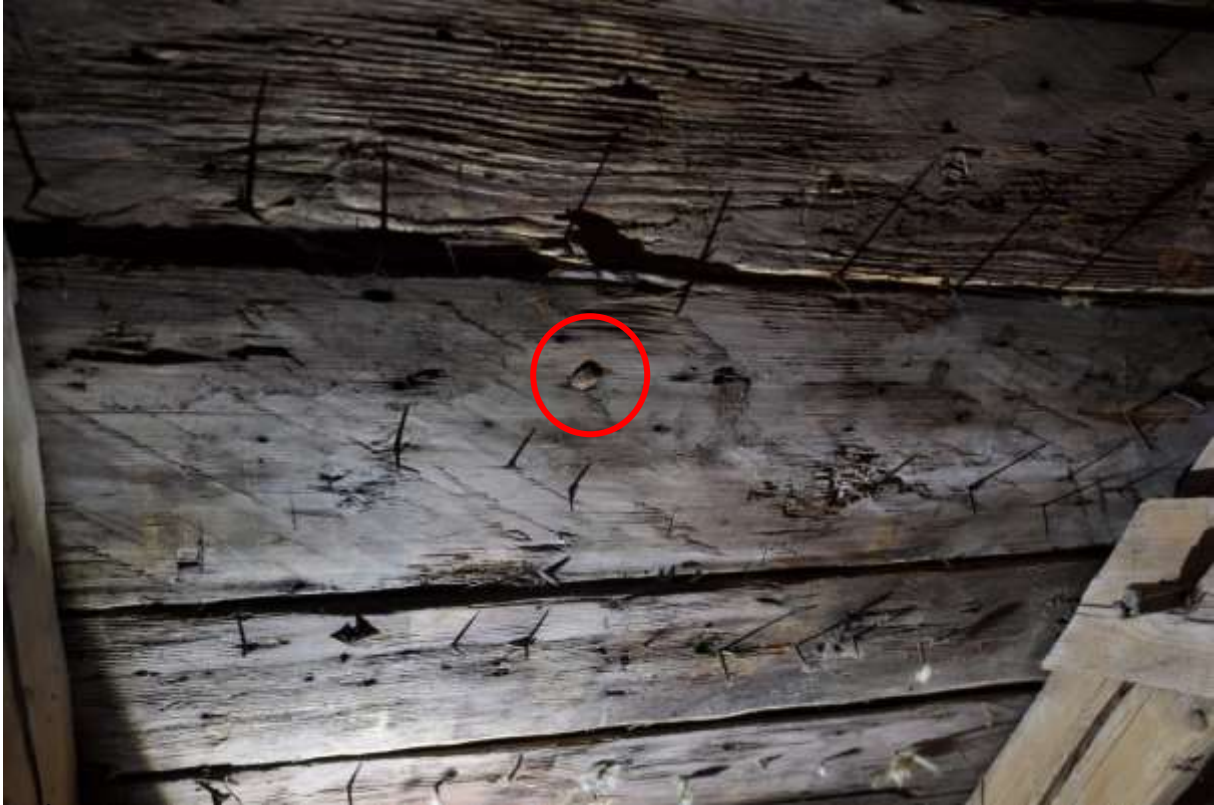
Återanvänd takbräda som tidigare suttit med andra sidan ut. Spikskallar syns här och var.
