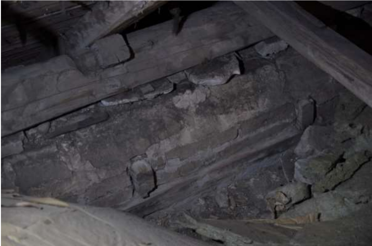
När isoleringen plockades bort frilades delar av det allra äldsta taklaget. På nedre delen av bilden syns ett inre remstycke samt två avhuggna bindbjälkar.
