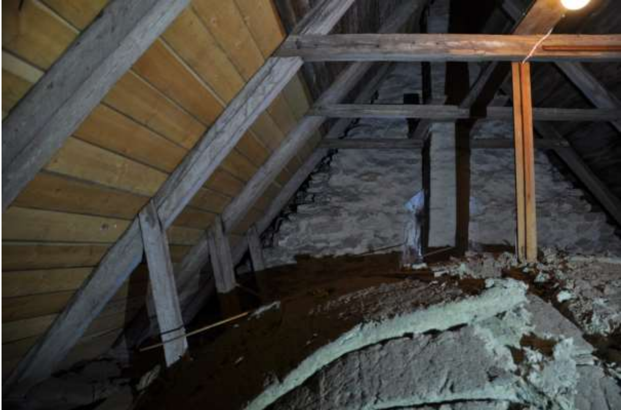
Sakristians taklag med snedställda stödben. Här syns också knutpunkter i samma utförande som i långhuset.
