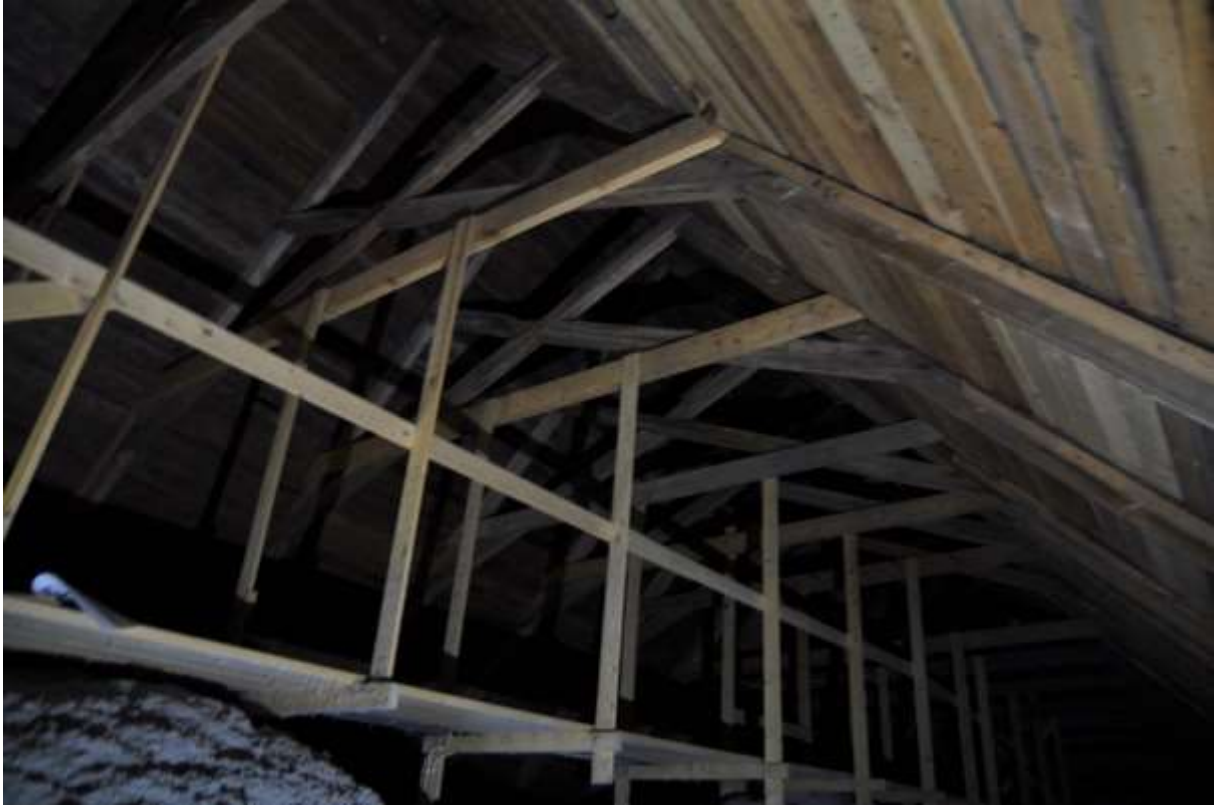
Sentida förstärkningar samt brygga stör bilden av det ursprungliga taklaget. Av den ursprungliga takstolen syns här högben samt kryss/saxsparrar.
