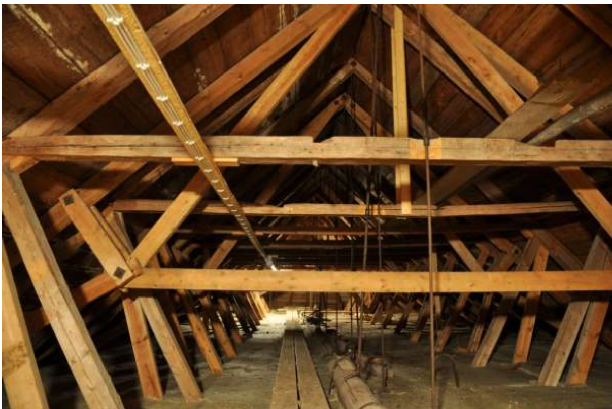
Ett 1700-talstaklag med många sentida förstärkningar. Ett återanvänt högben sitter nu som övre hanbjälke, närmast i bild.
