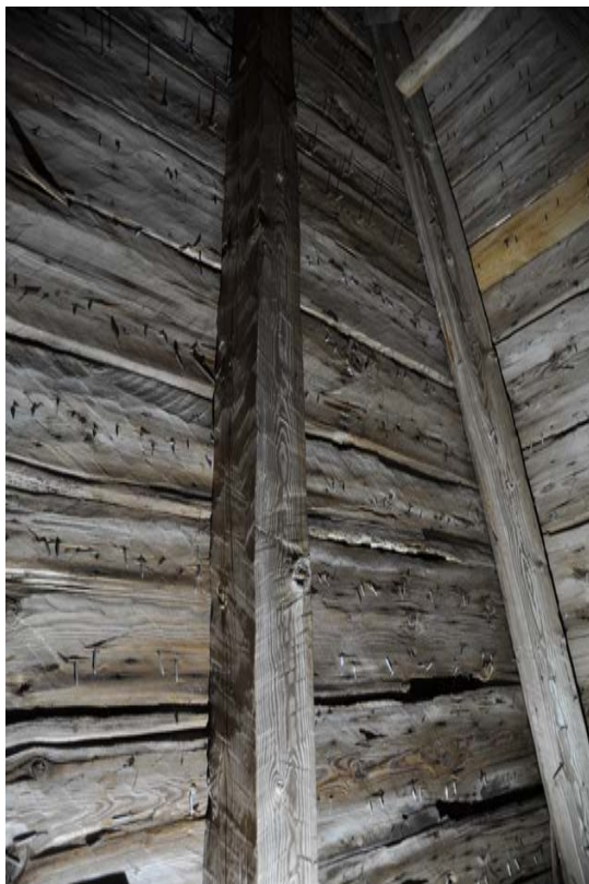
Bild från tornhuvens insida som visar sparrar och undertak, bearbetade med yxa i en medeltida behuggningsteknik kallad sprätthuggning.
