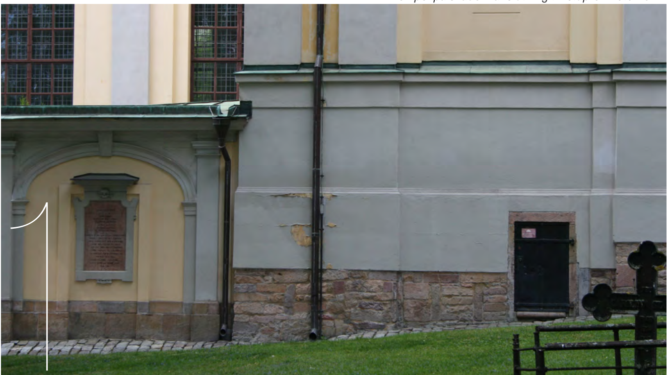
1. Exempel på skador i anslutning till stuprör. Foto 2012.
