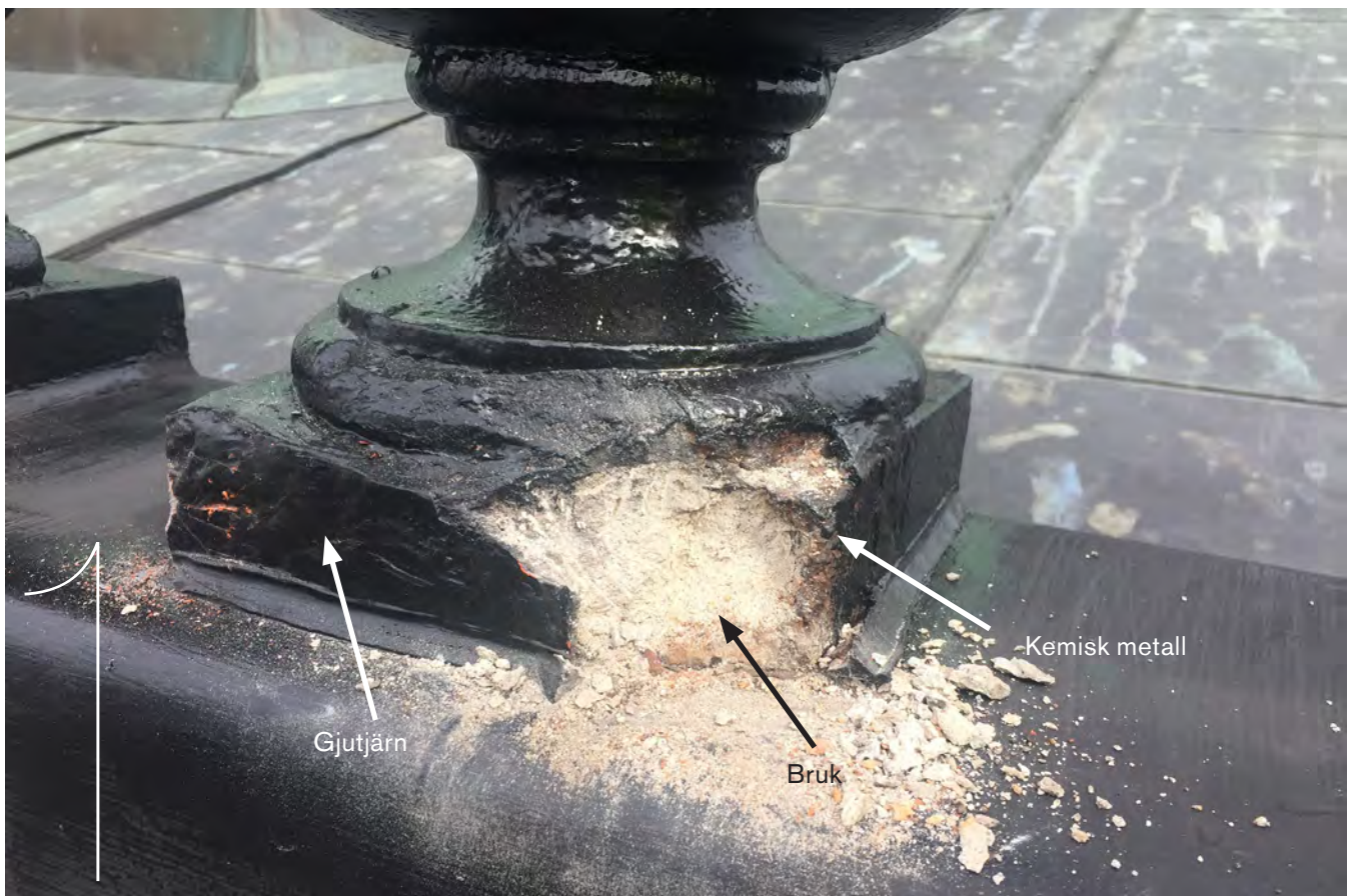
1. En baluster på den västra sidan var lagad med kemisk metall.
