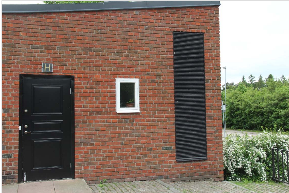
Figur. Vid någon tidpunkt har dörren vid ingång H på Tomaskyrkan bytts ut till en spegeldörr som helt saknar byggnadens modernistiska prägel. Foto: Helén Sjökvist.
