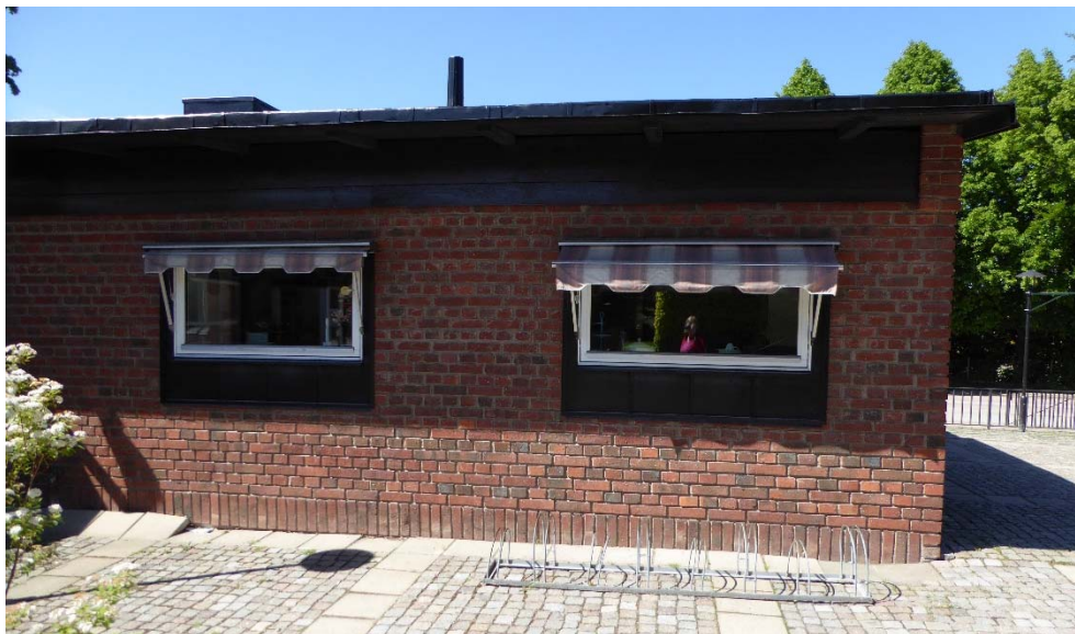
Figur. Fönstren till köket på Tomaskyrkan har förmins-kats och delvis satts igen. Foto: Helén Sjökvist.
