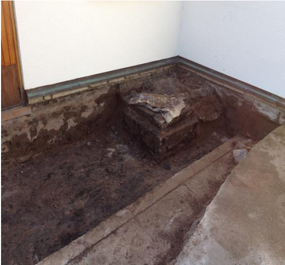
Läckage ner i källaren på krematoriet.
