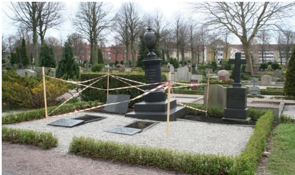
Figur 17. En hög gravvård som består av olika lutande delar. Är urnan fast monterad? Lutningen är så stor, redan vid okulär besiktning, att ommontering måste göras. I väntan på den bör gravplatsen av säkerhetsskäl spärras av.
