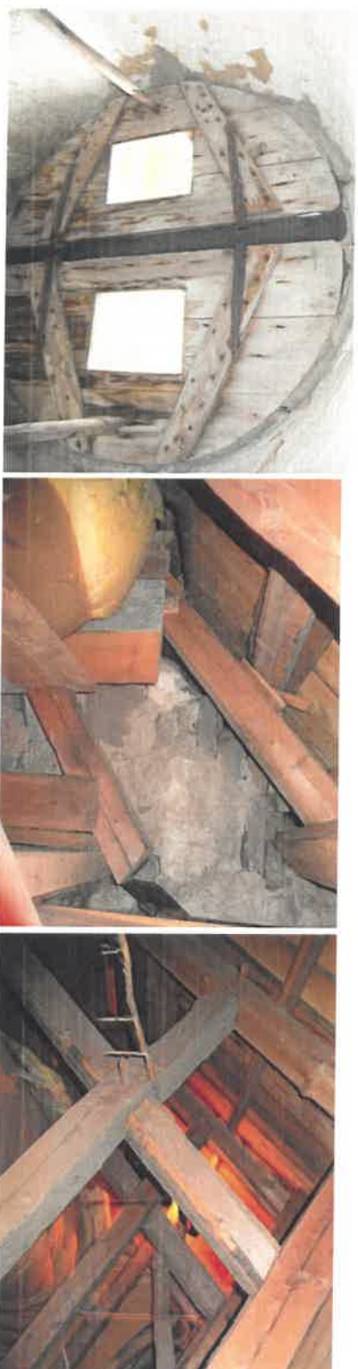
Bilder i tornvåningar med torn dörr, fönster, äldre delar av en predikstol samt takstegel och äldre skep med kyrkliga böcker och tidskrifter. Ljandukor med rötskador, kyrkvinden med träkonstruktion och takstol.
