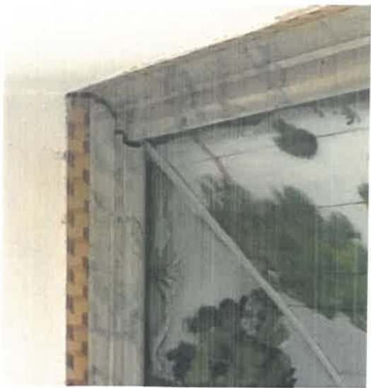
Skada i takfris som släppt från väggen i hörnet
