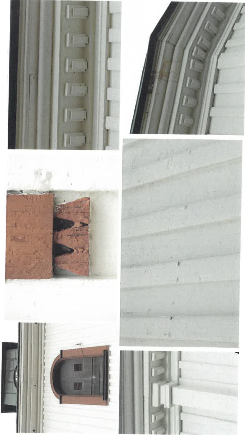
Foton på kyrkans tornlucka och fasaddetaljer som fönsterfoder, tandsnittfris, pilastrar med kapitäl samt äldre panellock sannolikt med handsmidd spik. Fukt problematik förekommer vid takfot.
