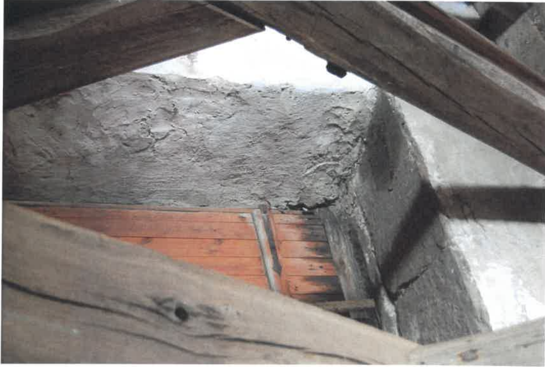
Foto på ljudlucka, timmer angripet av skadedjur och innetak med fuktproblematik.
