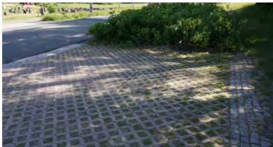
Längs huvudvägen i den södra delen av kyrkogården finns parkeringsytor som är täckta med gräsarmering av betonghålsten.
