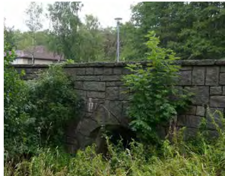
Växtlighet bör rensas bort runt bron så den blir synlig.
