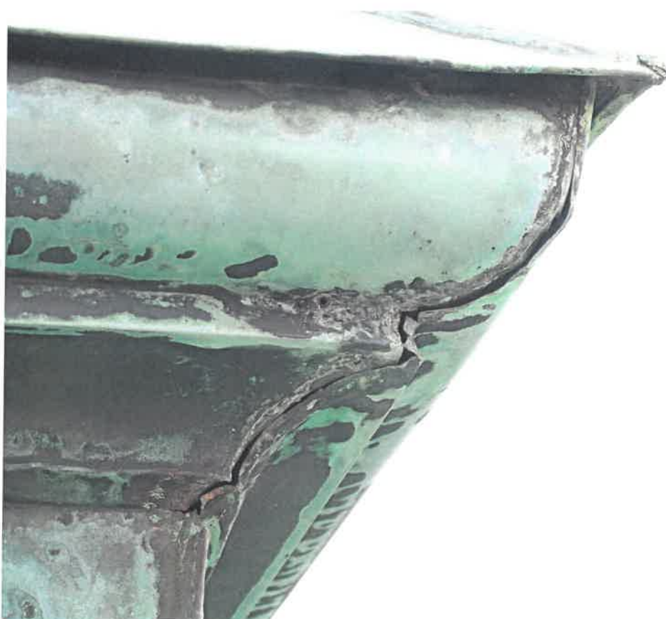
4. Tornhuv och lanternin har skador i kopparplåt, troligen i huvudsak lagd för minst 90 år sedan
