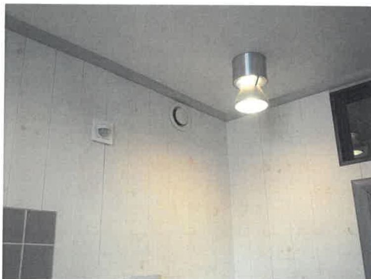
3. Kvistblödningar i Toalett finns i vägghpaneler
