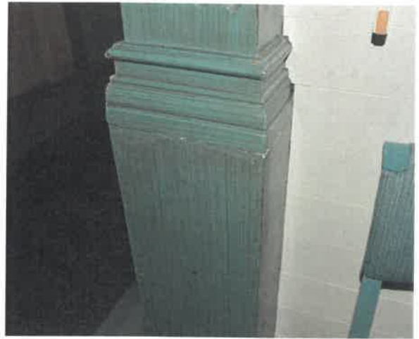
Läktarpelare med blåsbildning och pågående spjälkning.
