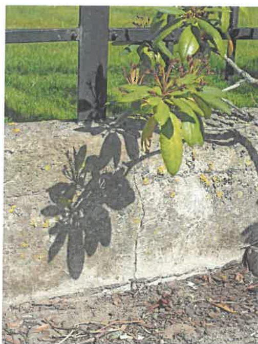
2. Sprickor i betongkantsten
