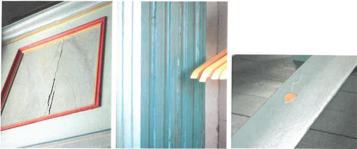
4. Läktarfront, pilastrar och bänkkvarter har mindre färgspjälkningar
