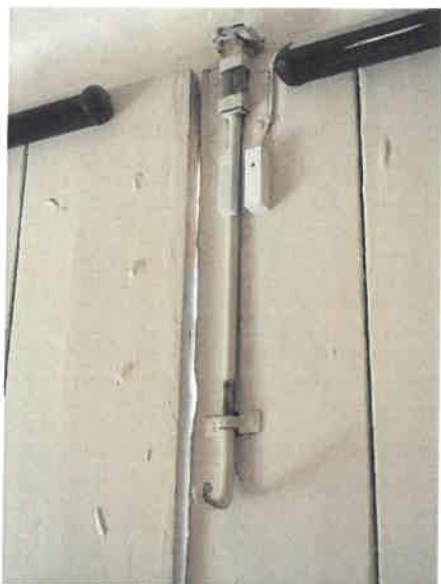
1. Ytterporten i väst har glipor p.g.a. skevningar i dörrbladen
