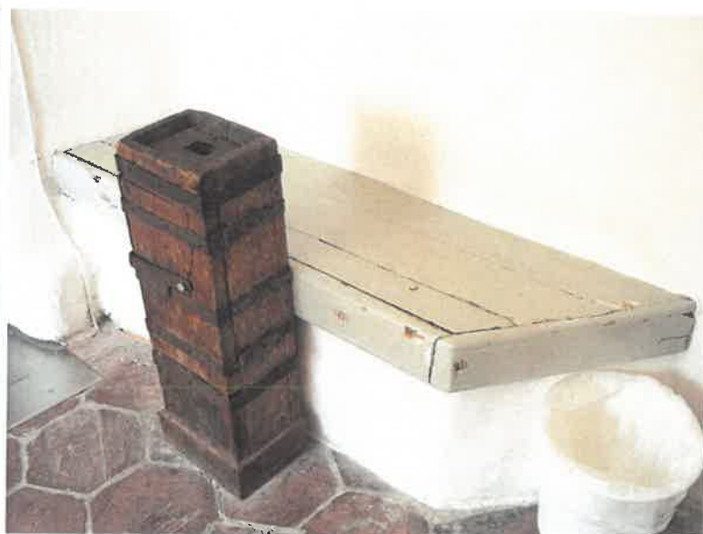
2. Väggfasta bänkar i Yttre vapenhus har stora ytskiktsskador
