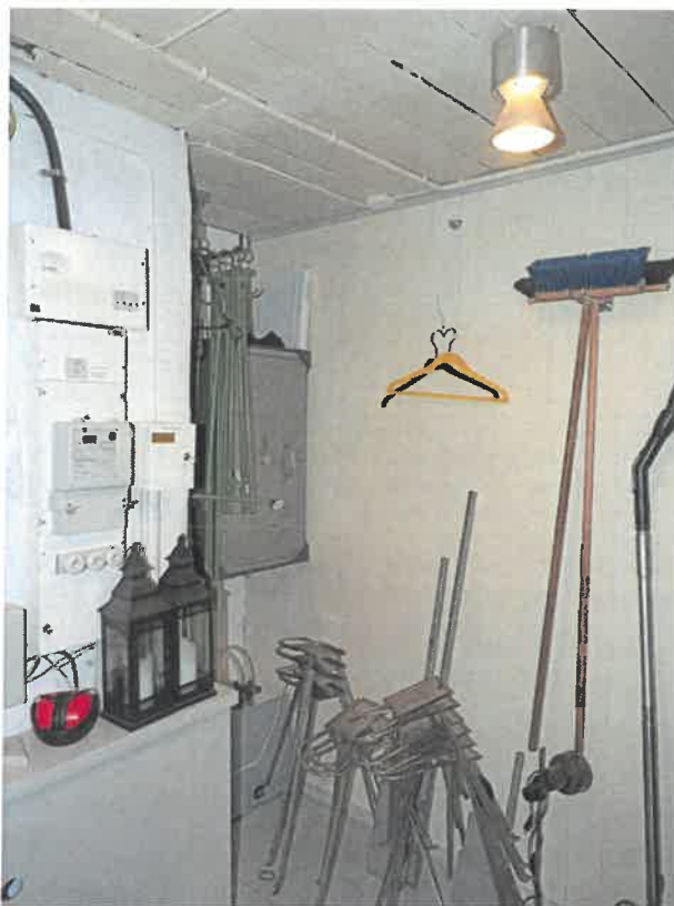
Inkommande servisledning och elmätare 63A
