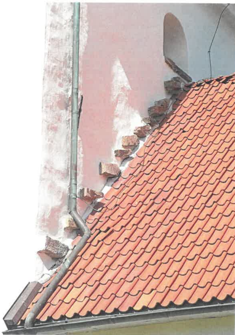
3. Takpannors anslutning mot tornet är av cementbruk vilken har sprickor och "nyper" sönder tegelpannor
