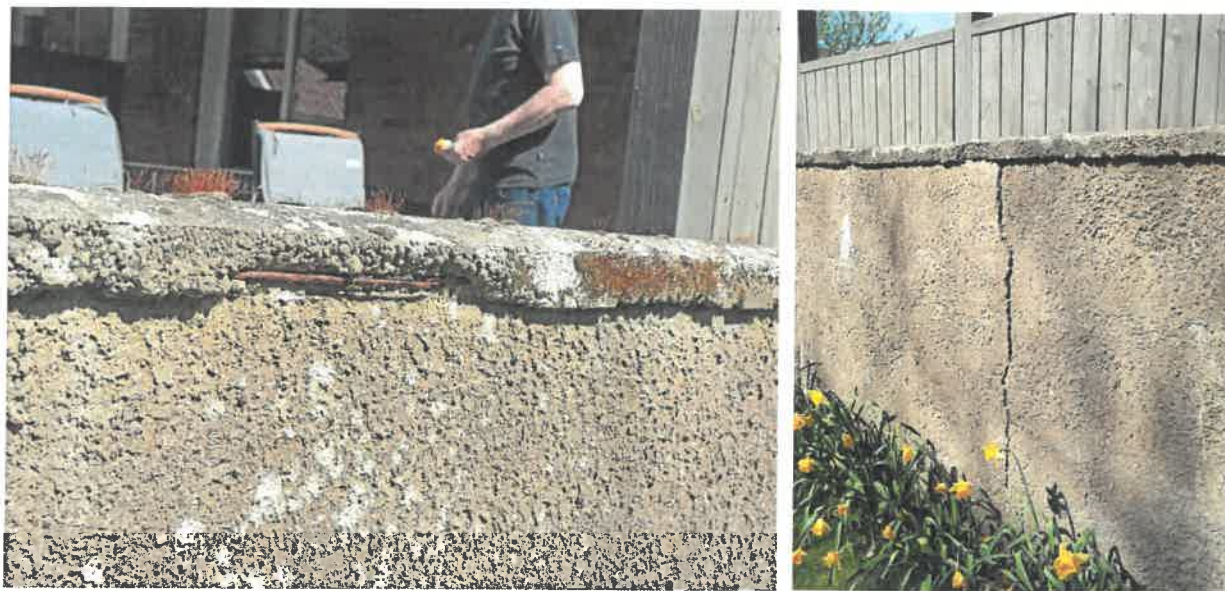
Spjälkningar och sprickor med blottad armering i mur mellan byggnader i norr
