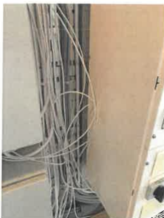
Lösa kablar dörrautomatik
