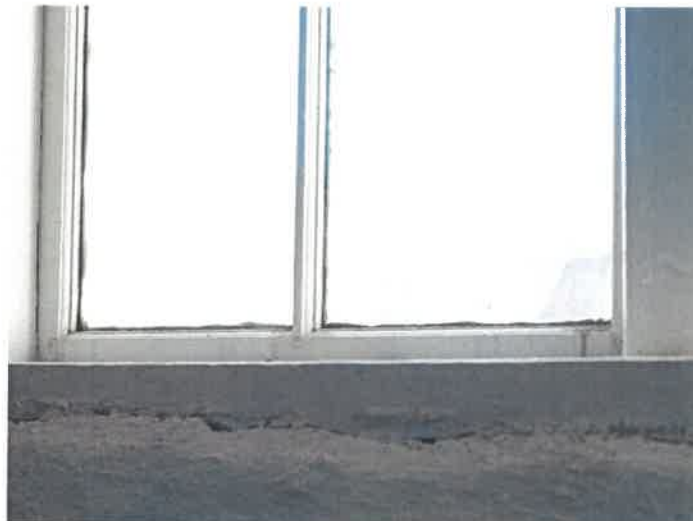
5. Västfönster i Tornrum i läktarplan har läckage genom kittning
