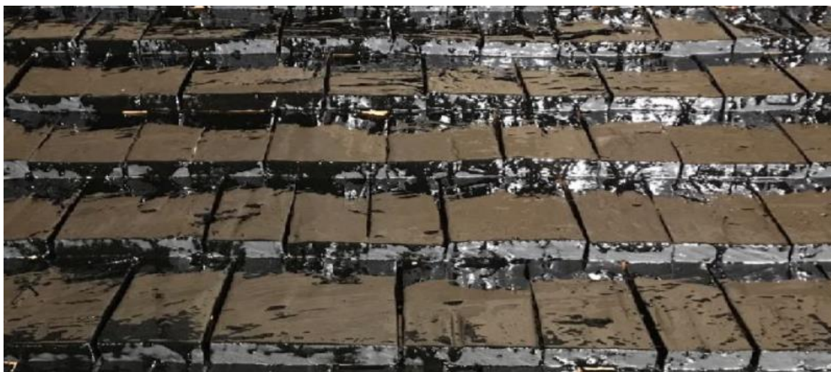
Figur 32: nysmort spåntak på Tiondeboden i Ingatorp. Förtjockad tjära som varar över tid. Foto: K. Melin.
