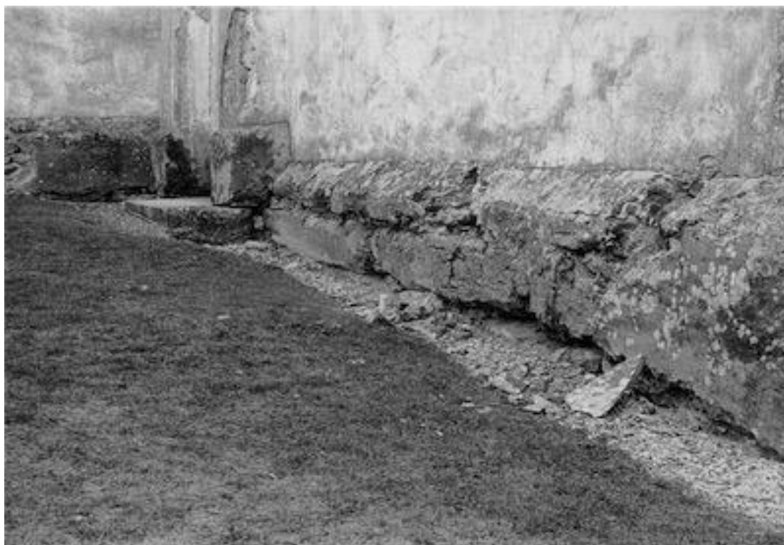
Sockeln på korets södra sida, sedd mot väster, strax innan den putsades över 1978. De tydliga skadorna är troligen från branden 1565. Foto Jan Utas, Gotlands Museum.
