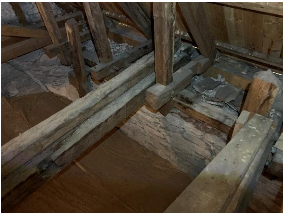
Murkrönet i långhusets sydöstra hörn sett mot sydöst. Tvärgående bjälkar, rior, för innertaket lagda på murarnas längsgående remstycken under takstolen. Foto JL 2020.
