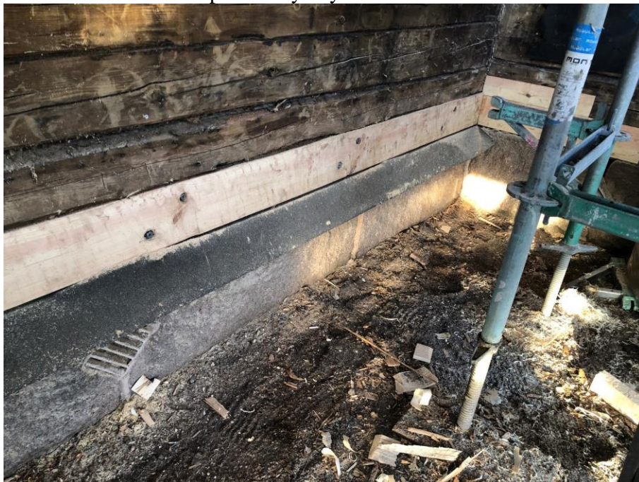
Skador till vänster om port. Utbytt syll.
