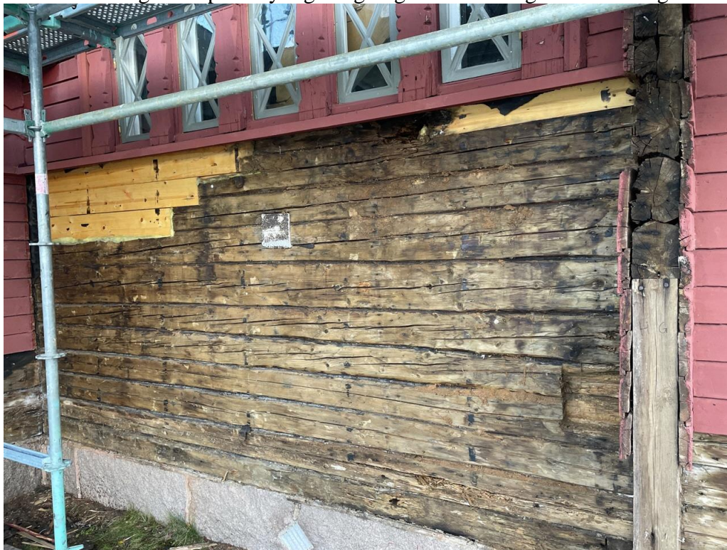
Skador till Höger om port. Synliga ilagningar är från tidigare renoveringar.
