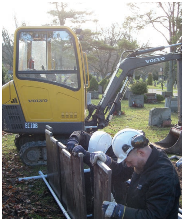
Skyddshjälm ska användas när man vistas inom en maskins arbetsområde.
