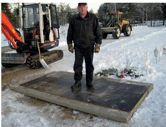
Efter grävningen täcks gravöppningen av en tättslutande skiva med hög hållfasthet för att förhindra olyckor.
