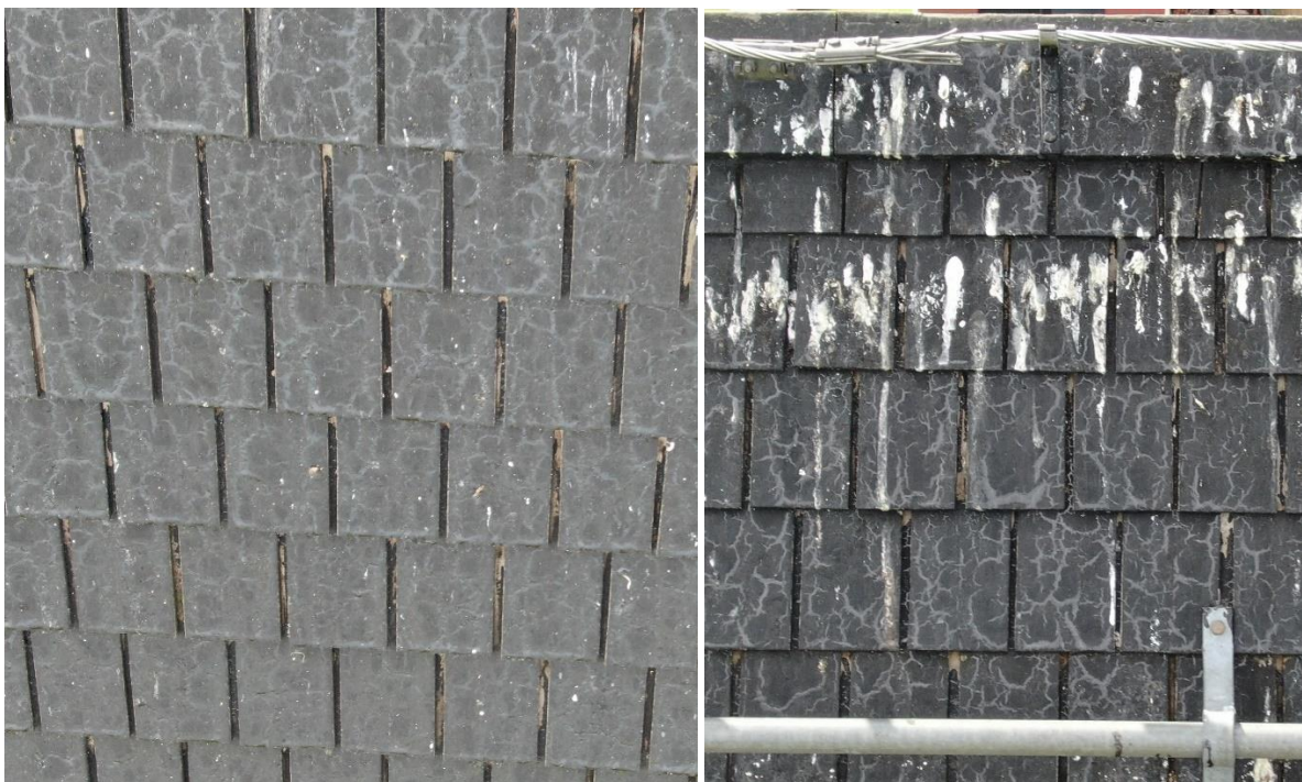
Närbilder på spåntakets norra takfall. Spånen har en heltäckande yta. I springorna kan man se att det finns bart trä utan täckande tjäryta.
