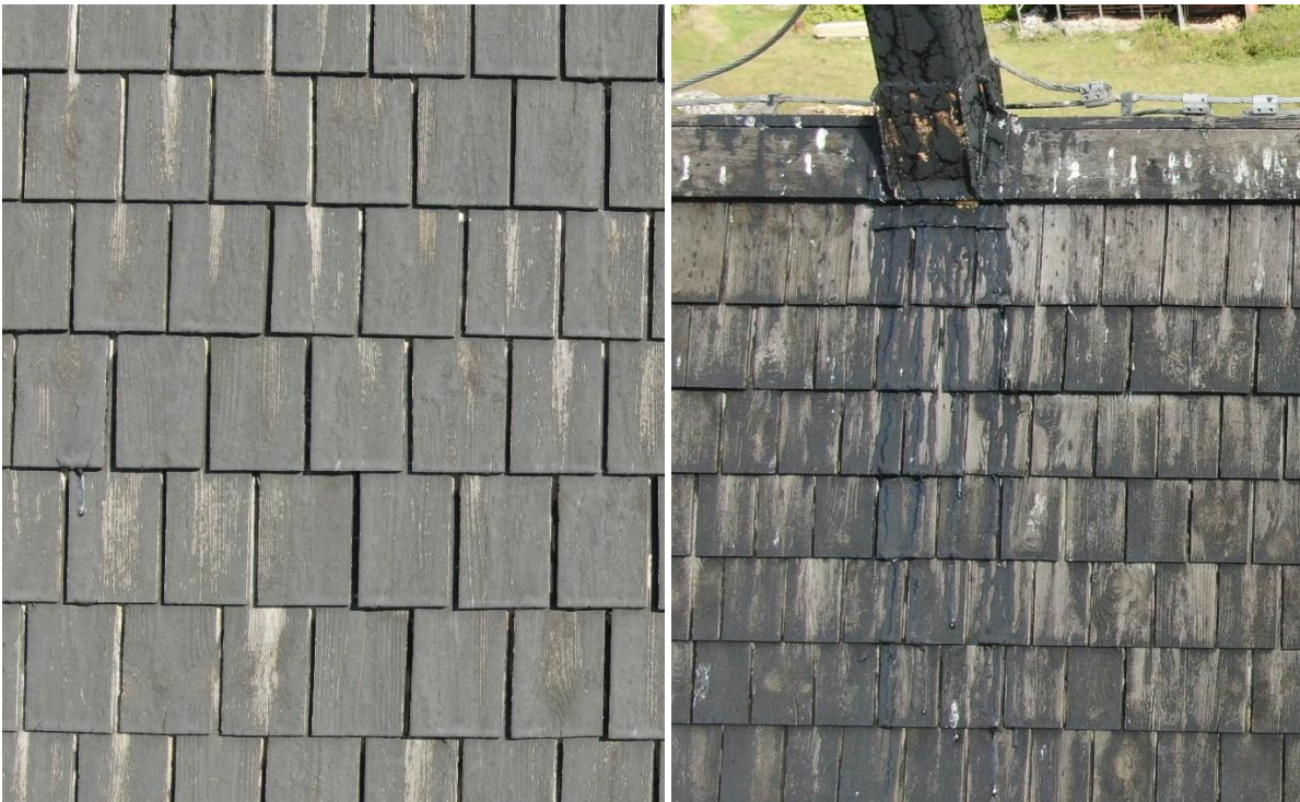
Flertalet spån har ännu kvar ett täckande tjärlager. Bild till höger, närbild på södra takfallets övre delar. Flera spån saknar i dessa partier en heltäckande tjäryta.
