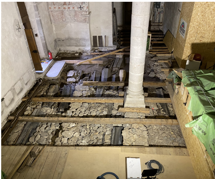
Delar av trägolvet i långhuset var skadat av hussvamp och fick bytas ut.
