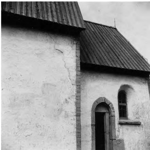
Långhusets sydöstra hörn och koret med sprickor kring triumfbågs-muren. Foto Erland Lagerlöf 197##. Gotlands Museums arkiv (GFF 892:17).
