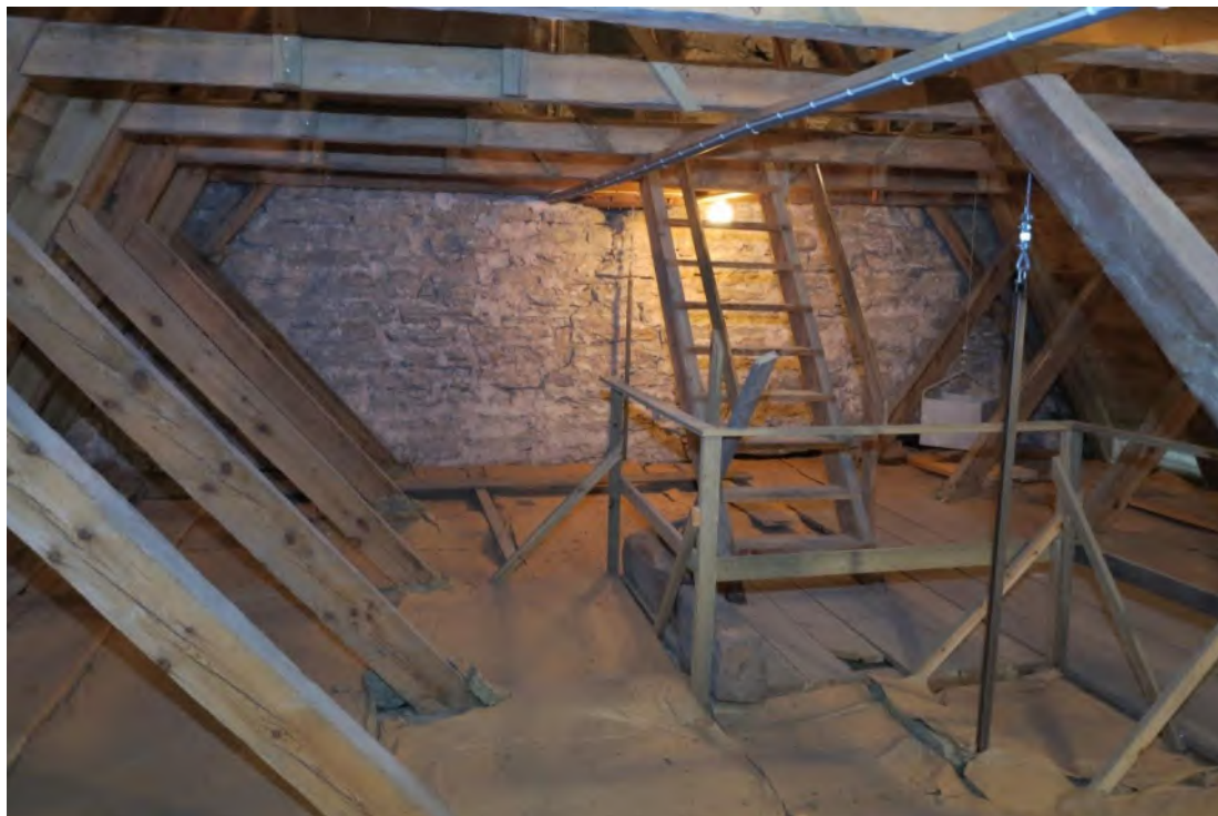
Långhusets vind, nedre delen sedd mot väster med ovsidan av innertaket och i fonden tornets östra mur. Foto JL 2019.
