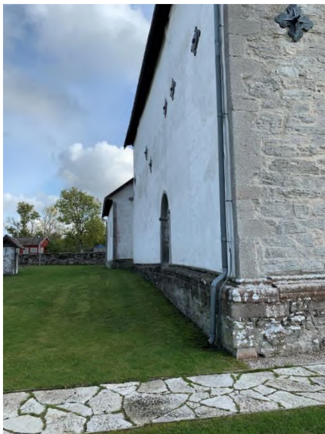
Långhusets nordfasad, sedd från väster. Sockeln visar sättningen i nordvästra hörnet. Foto JL 2019.
