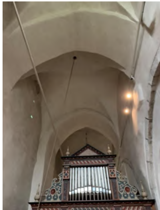
Västpartiet med tornets valv och genombrutna bågöppningar i söder och norr. JL 2019.
