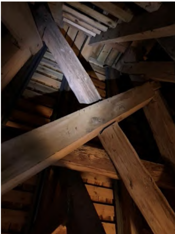
Tornhuvens bärkonstruktion. Knutpunkt mellan kryss och hörnstolpe. Krysset har hak och hål efter tidigare dymling. Foto JL 2019.
