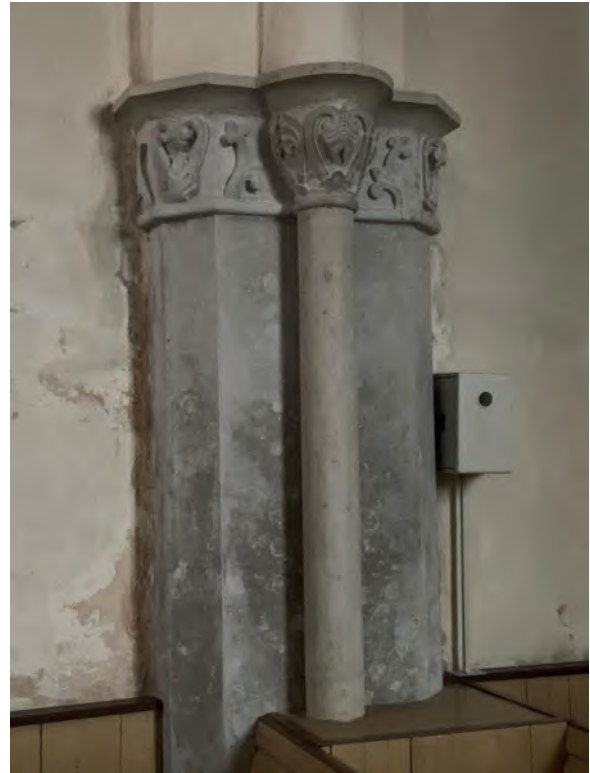
Triumfbågens södra vederlag. Nyhugget på 1950-talet efter det fragmentariskt bevarade brandskadade originalet. Foto JL 2019.
