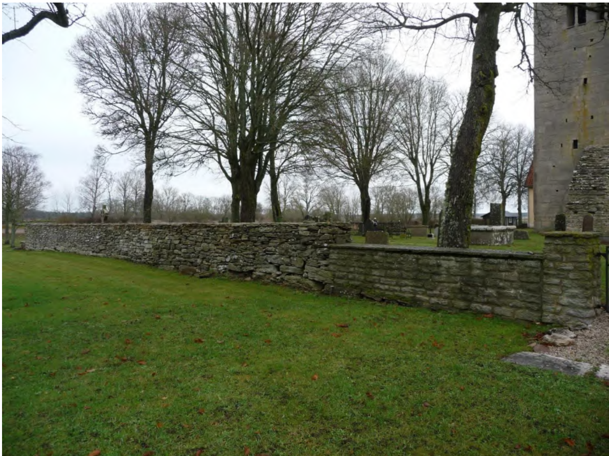
Den västra muren mot prästgårdsparken. Den borte högre delen av muren är av medeltida ursprung. Foto ES 2019.
