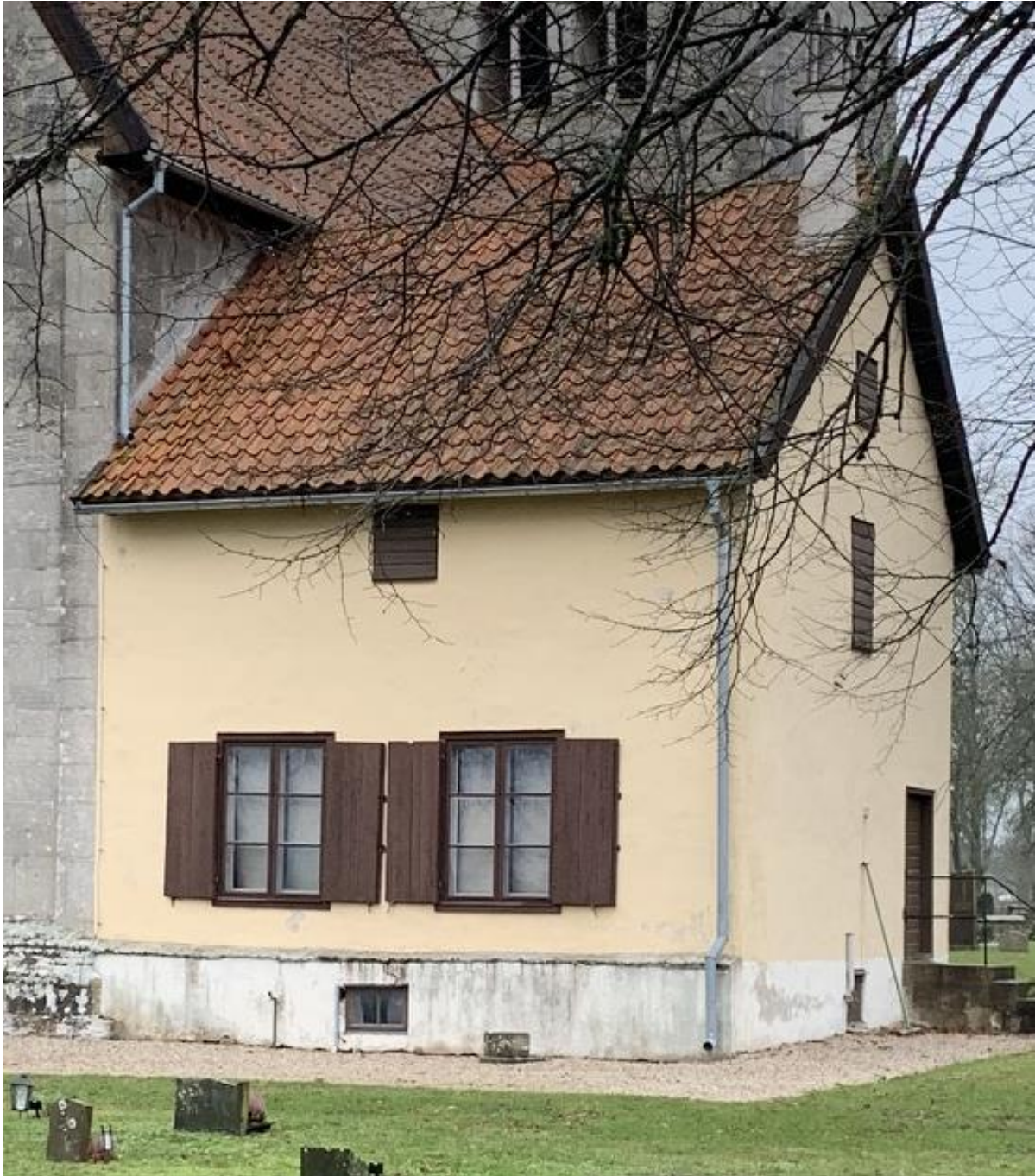
Sakristiebyggnaden från 1821 sedd från nordost. Sakristian innanför de stora fönstren fungerade även som folkskola med ingång genom dörren till höger. Från den nåddes även sockenmagasinet som inrymdes i övervåningen. Foto JL 2019.
