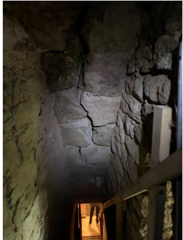
Trappa i tornets södra mur, sedd nedåt mot öster. Taket i trapploppet, utformat som sluttande plant tak istället för med annars gängse trappstegsformat tak. Längsgående spricka avspeglar sättningar i murverket. Foto JL 2019.
