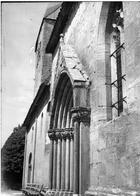
Södra fasaden sedd mot väster. Strävpelarna invuxna i murgroena. Foto Erik Bohrn 1938, RAÄ Kulturmiljöbild.
