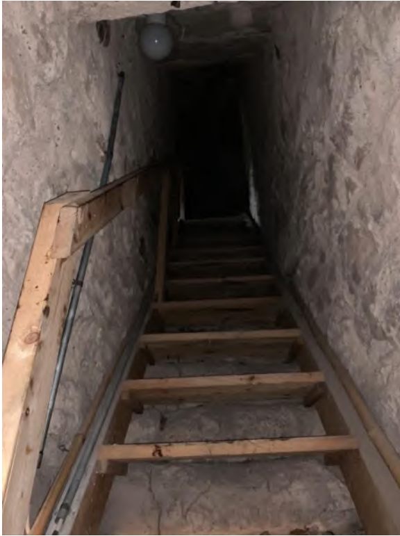
Trappa i tornets södra mur med trästeg ovanpå de starkt skadade murade stegen, sedd uppåt åt väster. Foto JL 2019.
