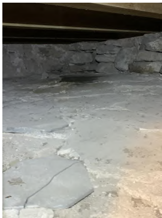
Ovansidan av valvet över tredje våningen, under däcket till klockvåningen, sett mot sydöst. Foto JL 2020.
