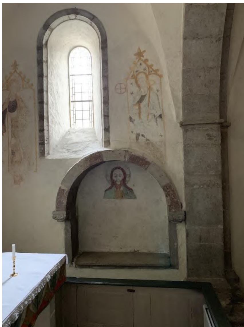
Sittnisch i korutsprångets södra mur. Troligen insatt vid 1200-talets slut i den befintliga äldre muren. Foto JL 2019.
