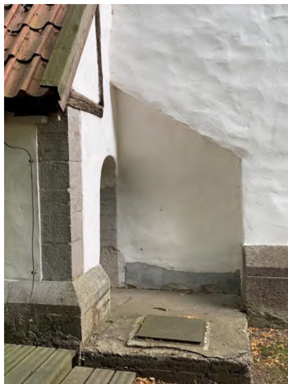
Ingång till sakristiabyggnadens västra kammare, nu driftrum, samt sparbåge i långhuset, sedd från norr. Foto JL 2019.
