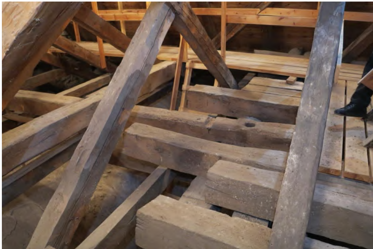
Bockkonstruktion och ansamling av grova bjälkar mitt över långhuset, möjligen en återstod av den tidigare takryttaren. Foto JL 2019.
