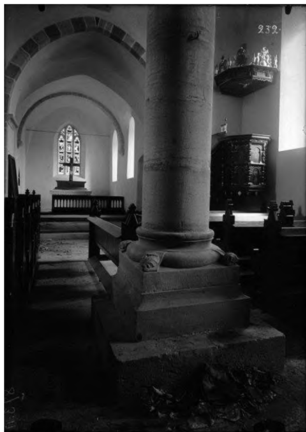
Interiör mot öster under restaureringsarbetets slutförande. Det romanska triumfkrucifixet på altaret, sannolikt provisoriskt. Foto Anders Roland 1910. RAÄ, Kulturmiljöbild.
