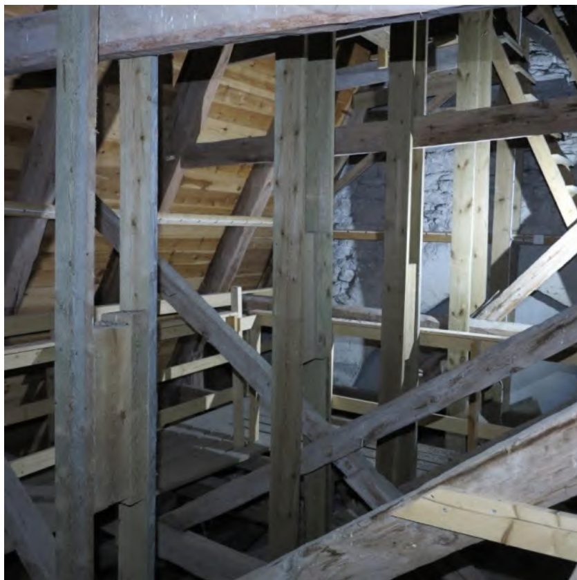
Korets vind sedd mot sydväst. Takstol från 1900-talet med inslag av äldre virken. Foto JL 2019.
