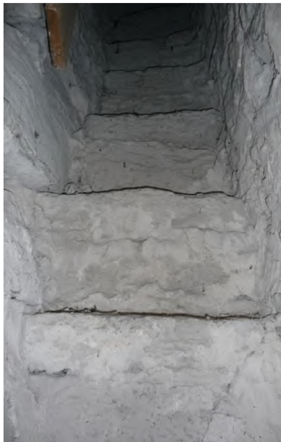
Brant trappa i korets norra mur, sedd mot väster. Foto ES 2019.
