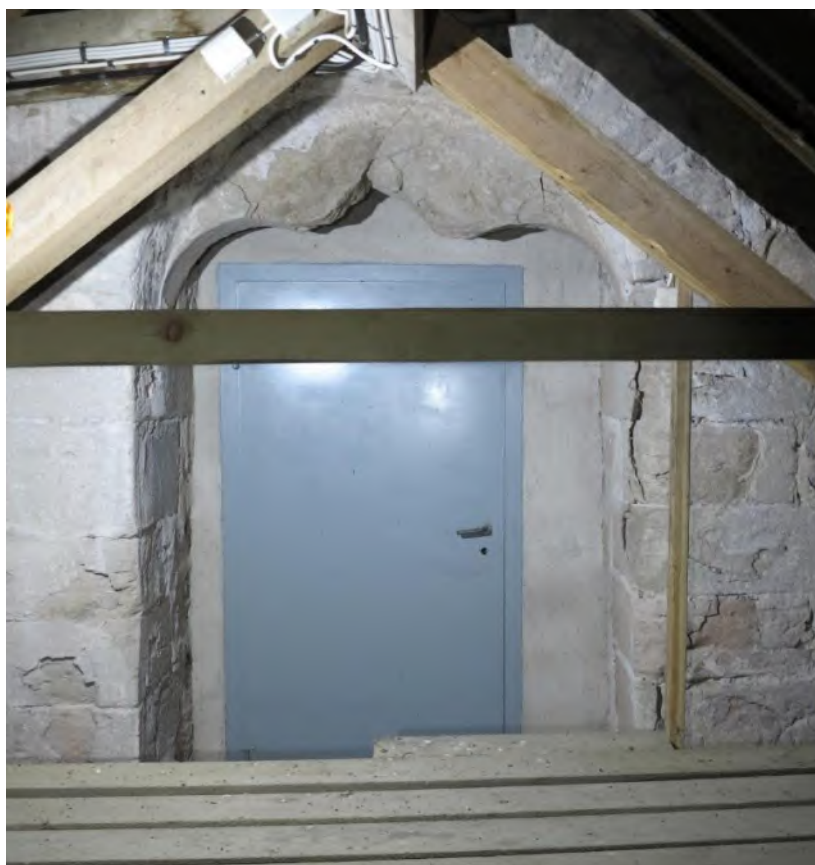
Den östra av tornets ursprungliga ljudgluggar med bevarade rester av en tvådelad bågöppning, sedd från långhusvinden. Det spjälkade murverket uppvisar skador från en brand vid okänd tidpunkt. Foto IL 2019.
