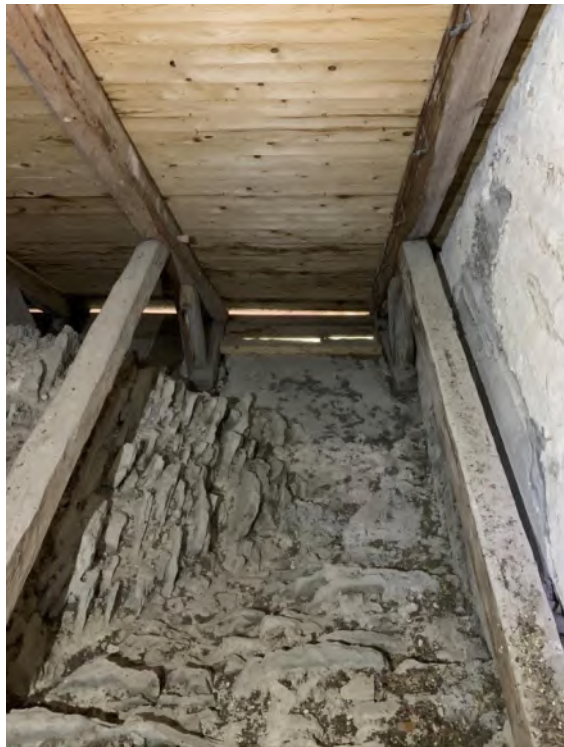
Korets vind sedd mot öster med öppning till absidens vind, upptagen på 1960-talet. Murens puts och detaljer i takstolens konstruktion kan tala för att rummet ursprungligen haft öppen takstol. Foto JL 2019.
