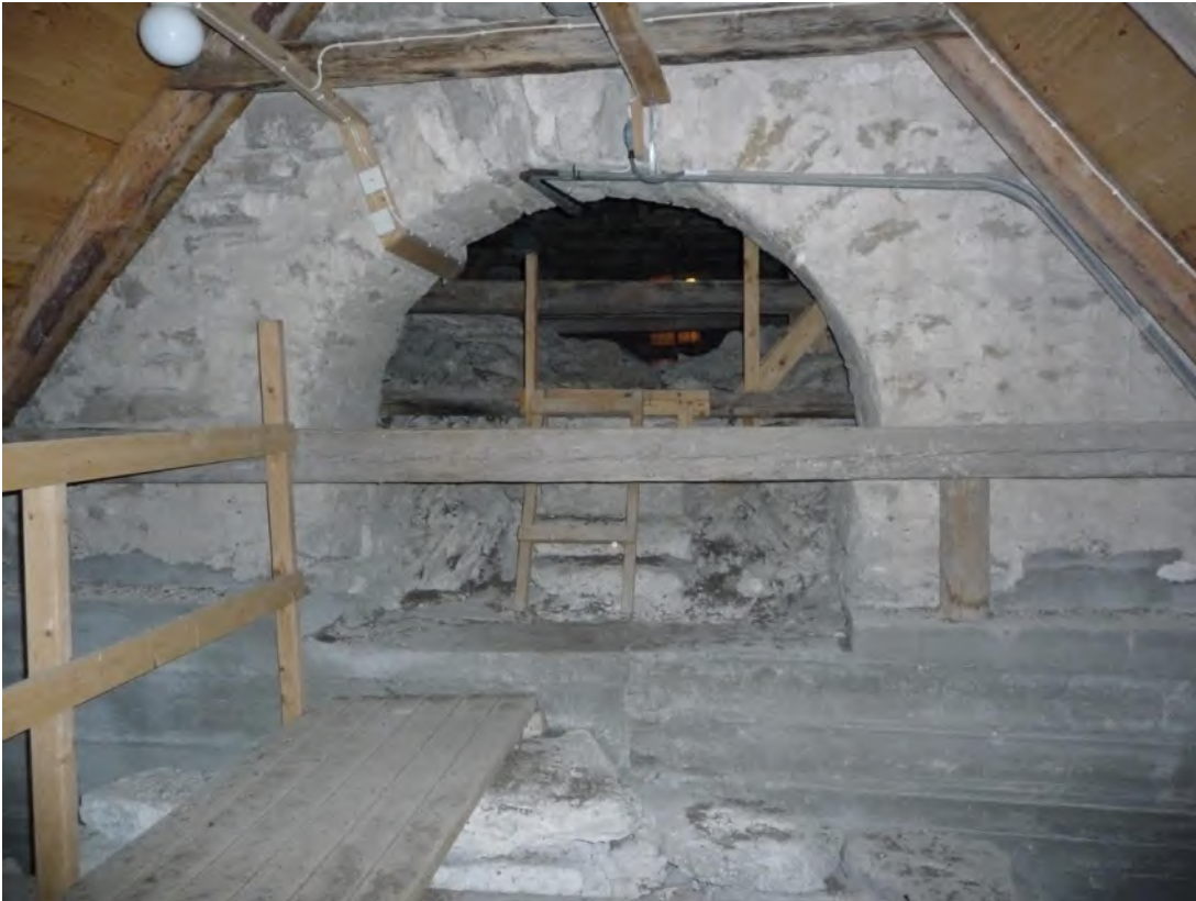
Korvinden mot väster med rundvälvd båge i långhusets östra mur. Korets västra mur synlig som murstenar strax ovan valvet. Betongförstärkningen från 1960-talet. Foto ES 2019.
