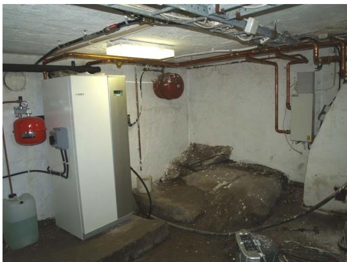
Yllestads kyrka bergvärmepump.
