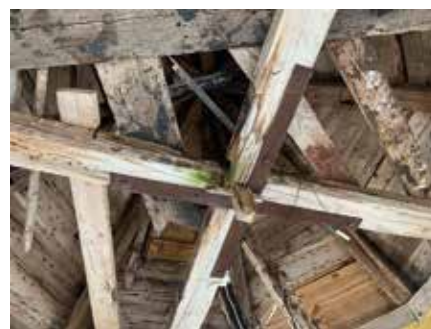
Den rötskadade konstruktionen. När förstärkningen i smide monterades ner gick bjälkarna av.
