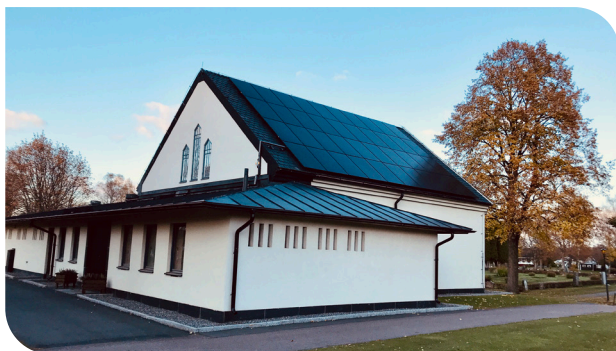
GRANGÄRDE KAPELL i Gränge-Säfsnäs församling med solpaneler monterade ovanpå ett skiffertak. Den installerade effekten är 13,4 kW och ska årligen producera runt 12 000 kWh. Foto: Stefan Enerud - Svesol
