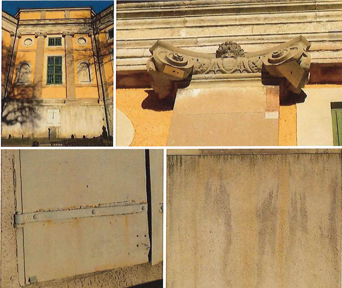
Figur 9 – Överst fr. v: Översiktsbild på den sydvästra fasaden. Pilastrarnas kapitäl har delvis säkrade voluter. Underst fr. v: Sockelns plåtlucka har rostutfällningar. Sockeln är flammig av rinningar.
