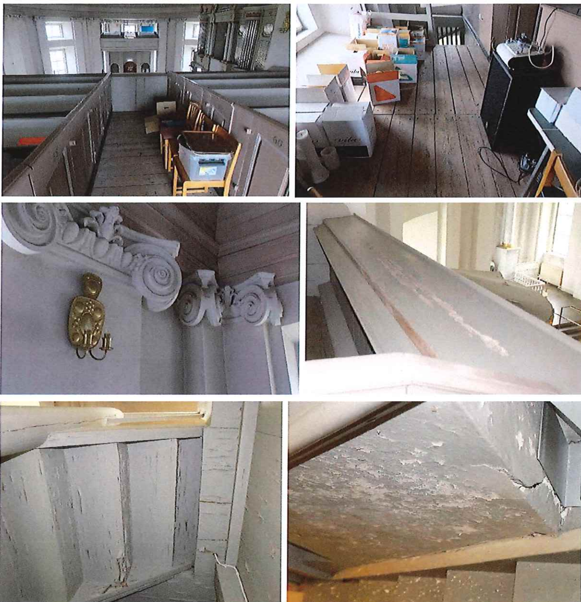
Figur 18 - Överst fr. v: Översiktsbild över den östra läktaren. Kartonger placerade på golvet ger läktaren ett stökigt uttryck. Mitten fr. v: Flera kapital har sprickor och utgör en säkerhetsrisk. Läktarbarriären har partiellt kraftigt färgbortfall. Underst fr. v: Trappans undersida har kraftig färgflagning. Den östra väggen i trapploppet har en puts-skada, bomputs och kraftigt flagnande bemålning.
