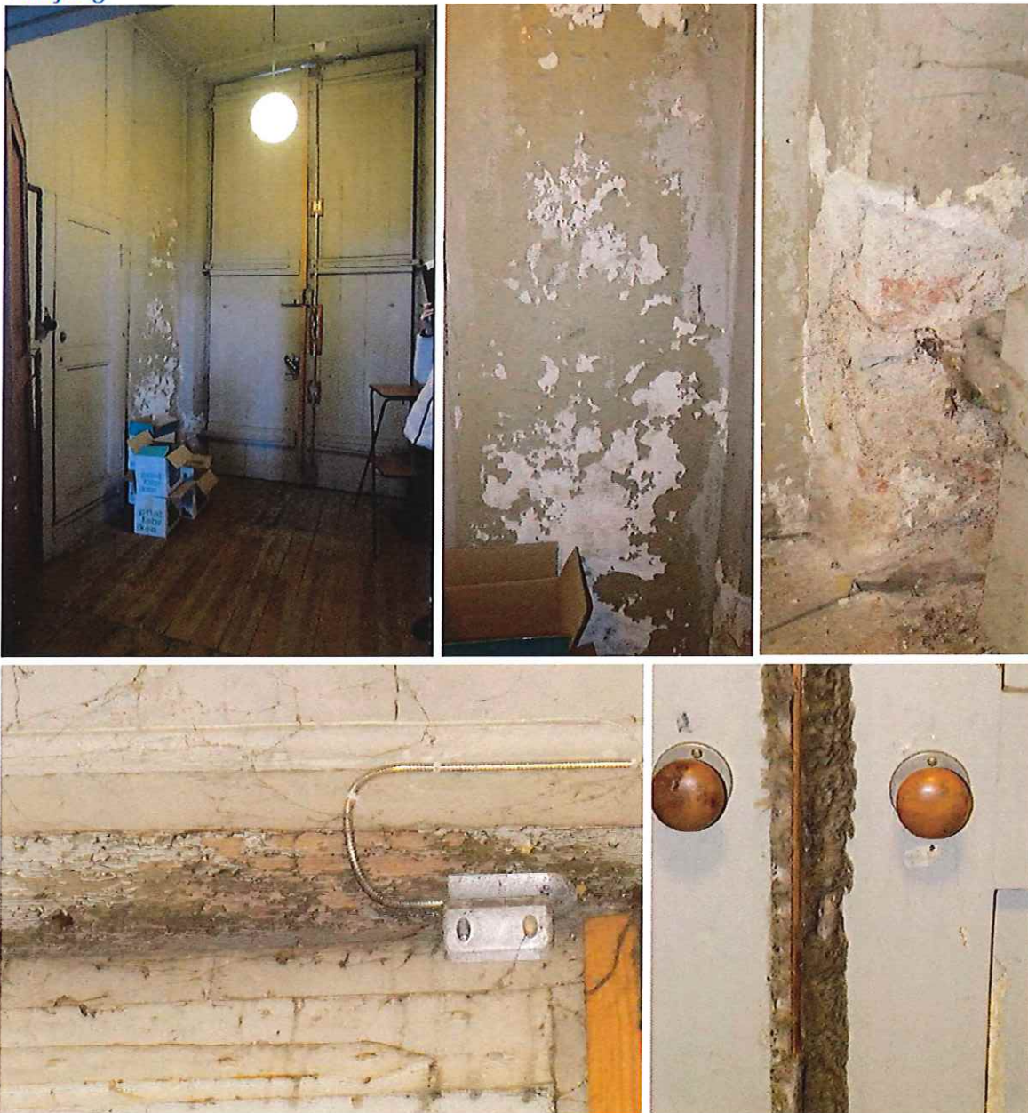
Figur 14 – Överst fr. v: Översiktsbild över det östra vindfånget. Kraftig färgflagning på putsat väggparti. Putsskada i anslutning till entréportens muröppning. Underst fr. v: Färgflagning på entréportens övre karmbalk. Flera av dörrarna har fårskinnstättning i dåligt skick.
