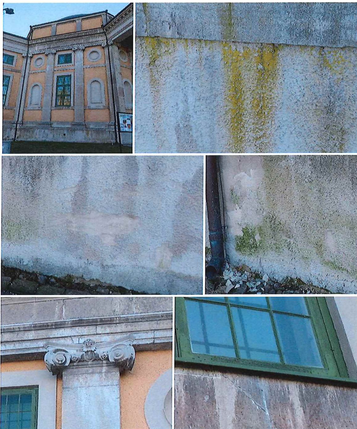
Figur 5 – Överst fr. v: Översiktsbild över den nordöstra fasaden. Påväxt på den nordöstra sockeln. Mitten fr. v: Påkörningsskada från bil i sockeln. Putsbortfall och algpåväxt på sockeln. Underst fr. v: Materialbortfall från voluterna på pilastrarnas kapitäl. Mindre färgflagnig på fönsterbåge.
