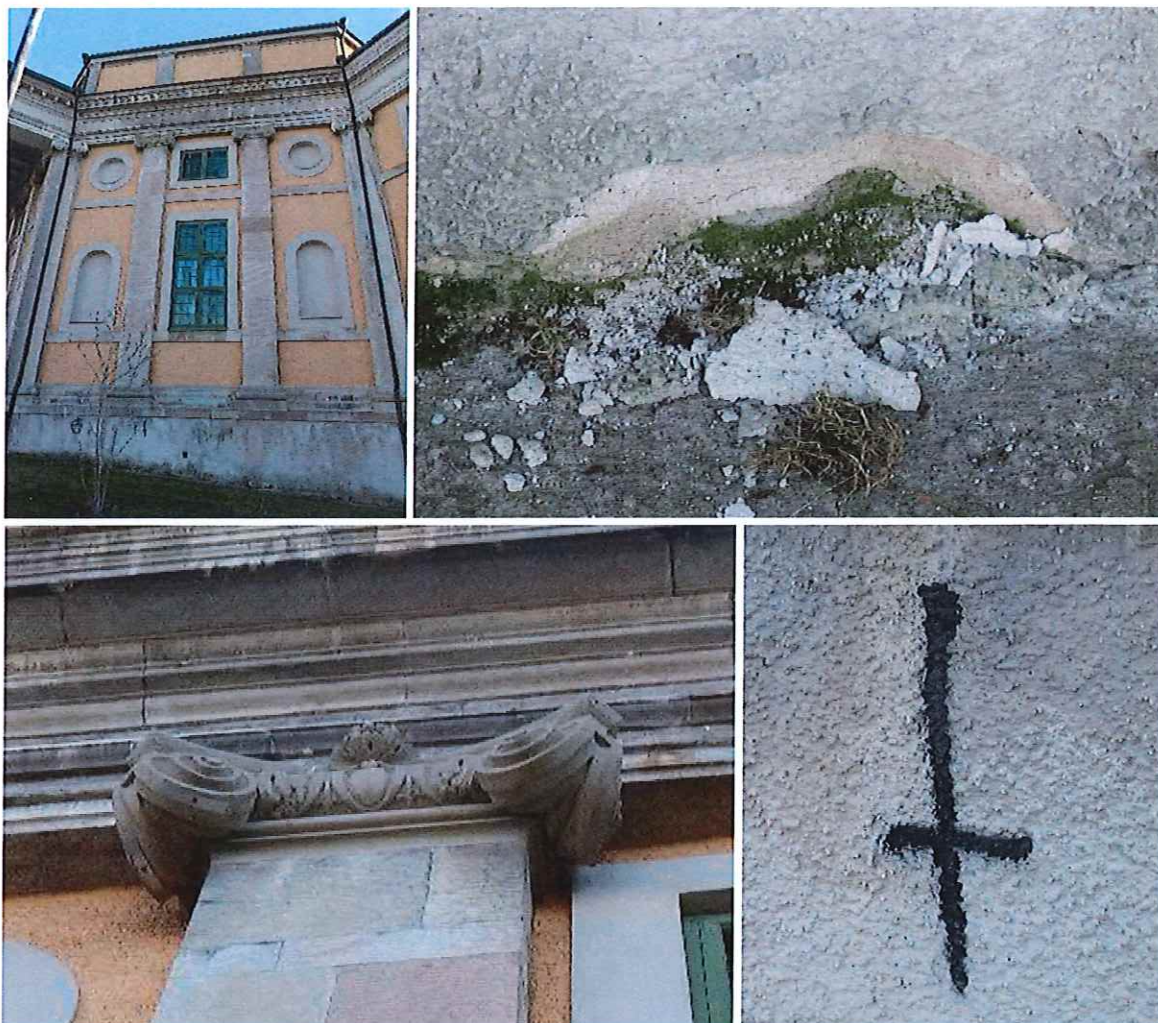
Figur 3 – Överst fr. v: Översiktsbild på den nordvästra fasaden. Bortfall av spritputs på sockeln. Underst fr. v: Kapitäl med säkrade voluter. Klotter förekommer på sockeln.
