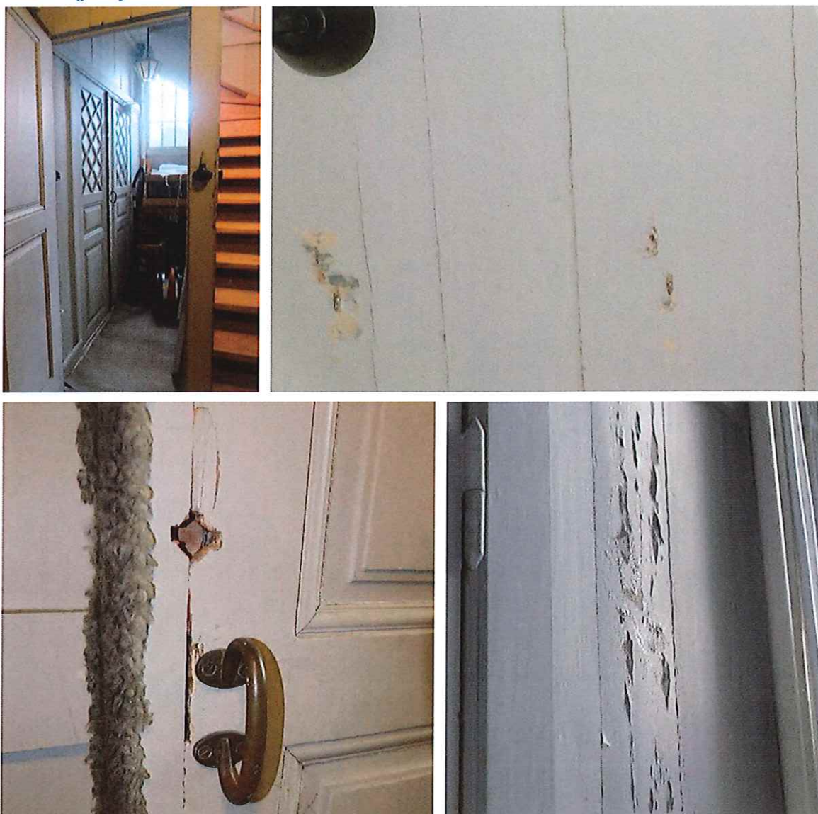
Figur 15 – Överst fr. v: Översiktsbild över det norra förrådet i den östra korsarmen. Enstaka partier med bortnött färg i taket. Underst fr. v: Den södra dörren har hål efter ett annat handtag eller likande. Utrymmet har partiellt flagnande bemålning.
