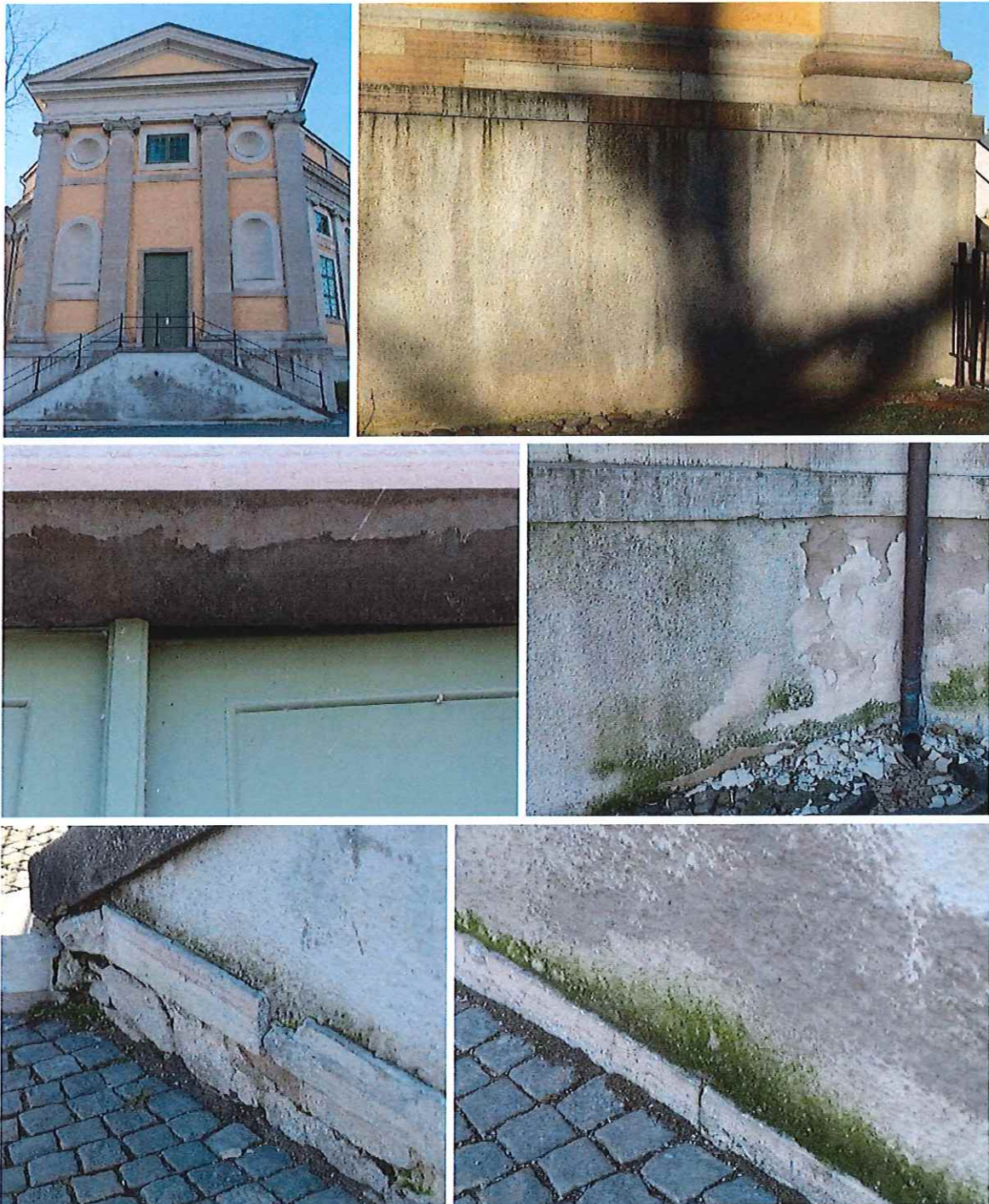
Figur 6 – Överst fr. v: Översiktsbild på den östra korsarmen. Sockeln är flammig av rinningar och påväxt. Mitten fr. v: Det norra dörrbladet sluter inte tätt. Putsbortfall och algpåväxt på den östra korsarmens sockel. Underst fr. v: Sockeln till den östra trappans sidostycke är i dåligt skick. Algpåväxt på den östra trappans sidostycke.
