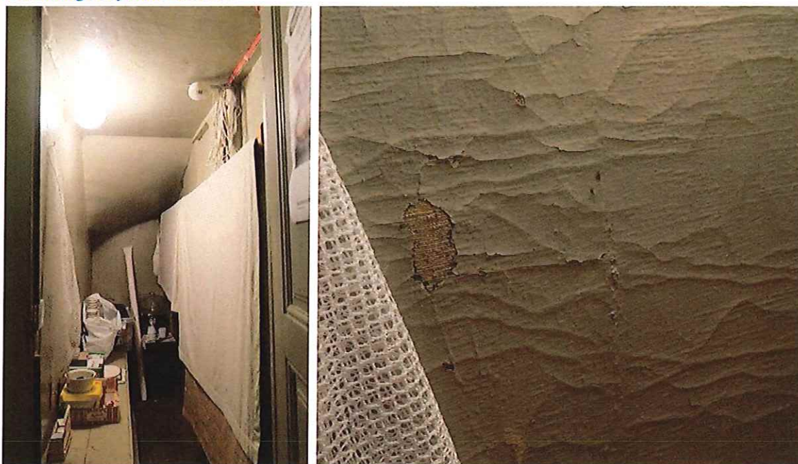
Figur 17 - Fr. v: Översiktbild över den östra korsarmens södra förvaringsutrymme. Bemålningen på de vävspända väggarna har sprickor och flagnar något.
