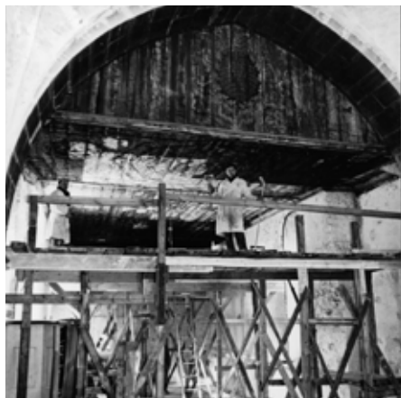
Interiör mot väster under restaureringen 1965. Innertaket rengörs från sot från kaminen. Foto troligen Erik Olsson Sanda, ATA
