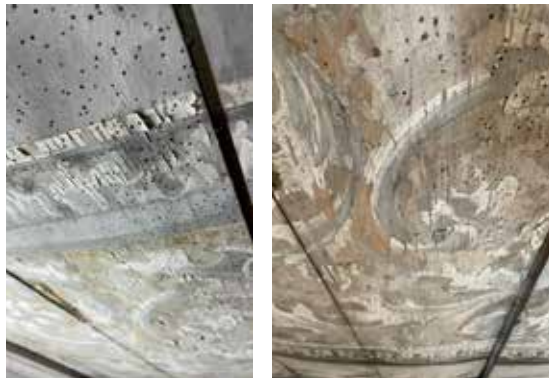
Skador på innertakets måleri, sett på nära håll före konserve- ringen. Foto Susanna Barros Eriksson 2022.
